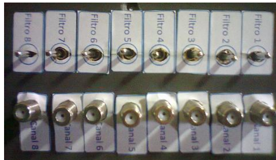
Figura 4.26 Conectores de cable coaxial y filtros opcionales.
