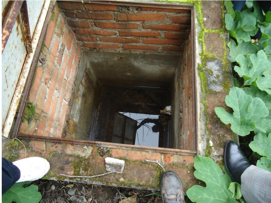
Grafica 5. Tanque 1 para el Abastecimiento de Agua para Shuyo Chico
