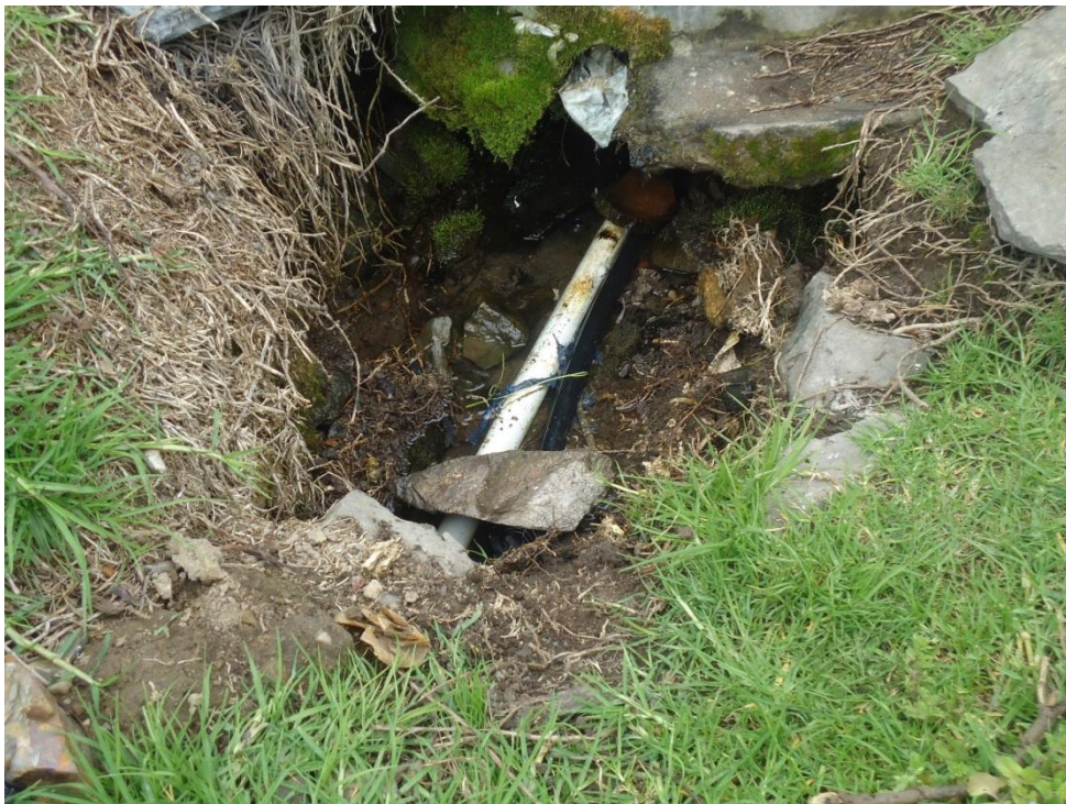
Grafica 8. Salida de Conducción de Tanque de Captación #2
