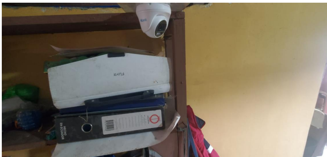
Figura E2. Instalación cámara domo en la cocina
