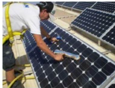
Gráfico 53: Limpieza de Paneles Fotovoltaicos
