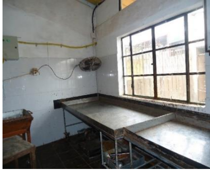
Figura 6.174 Espacio físico destinado para la instalación de la máquina
