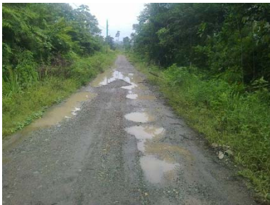
Superficie de rodadura deteriorada
