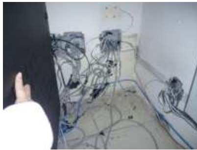
Fig. 23 Instalaciones Eléctricas (Parte posterior del rack)
