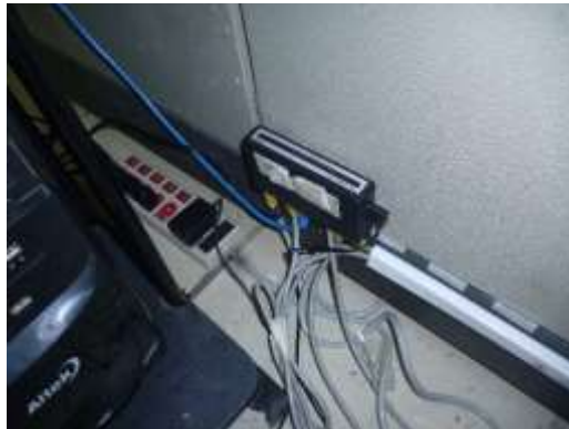
Fig. 25 Instalaciones improvisadas de red
