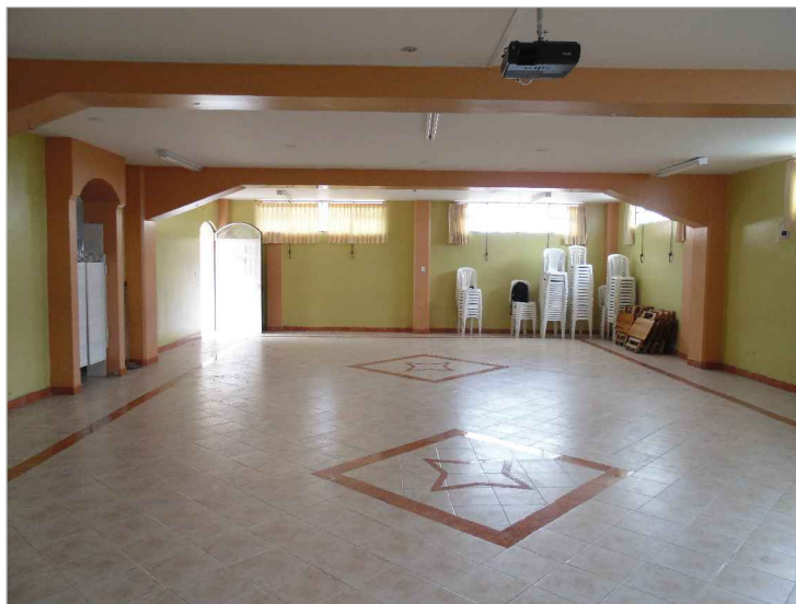
Carencia de ventilación natural y artificial
