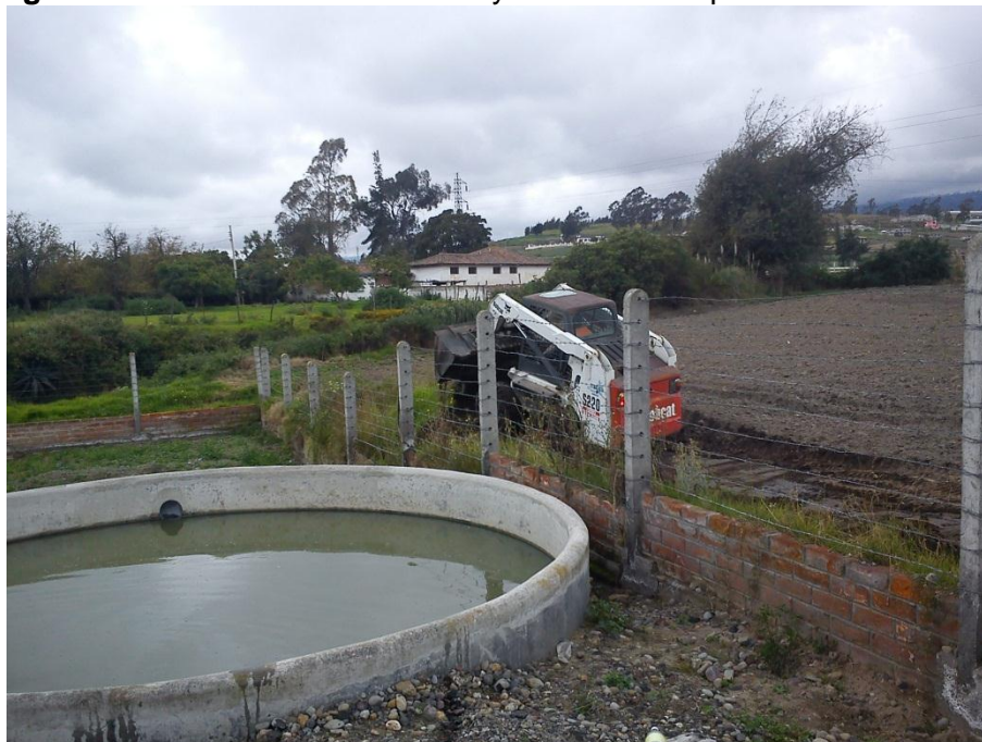
Imagen D.4. Eliminación de maleza y relleno de la quebrada Puerto Arturo
