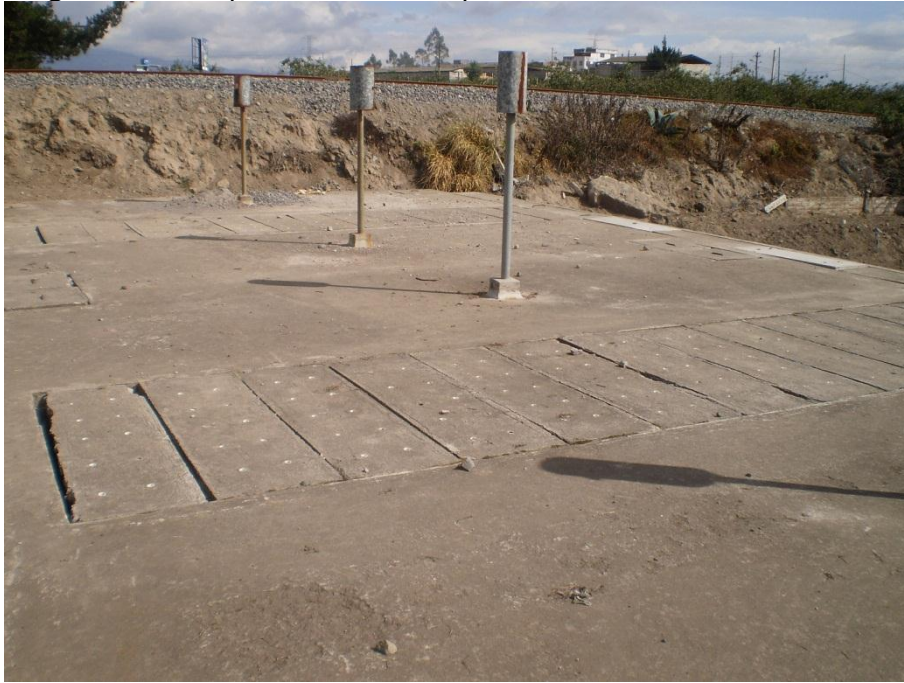
Imagen D.7. Tanque sedimentador planta de tratamiento Puerto Arturo
