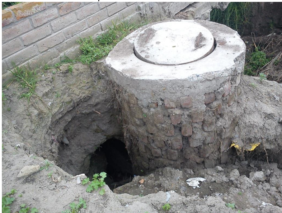
Imagen D.2. Caja de descarga de caudales de la planta de tratamiento Puerto Arturo previo mantenimiento.
