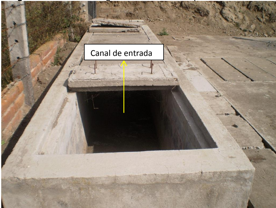
Imagen D.6. Entrada de agua contaminada a la planta de tratamiento
