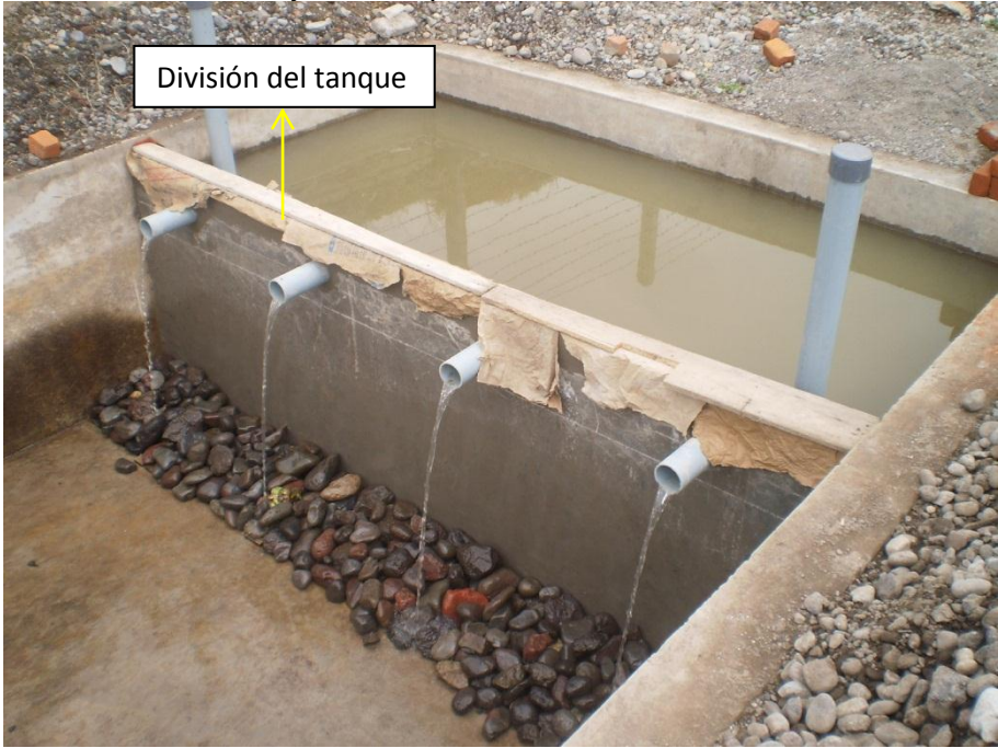
Imagen D.13. Construcción del tanque mixto con lechuguín, tubos PVC, arena de cuarzo y filtro de piedra descendente
