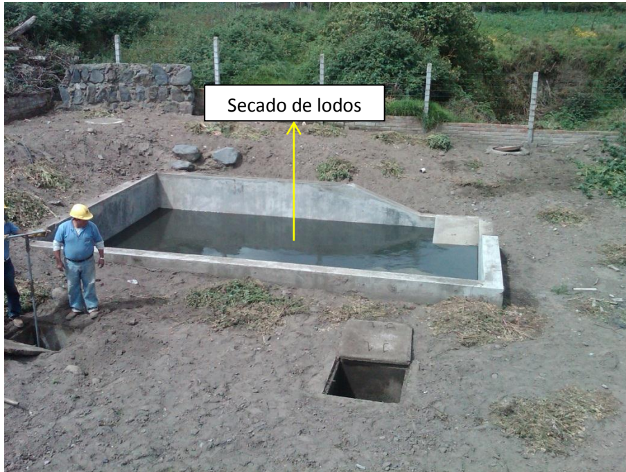
Imagen D.11. Descarga de contenido del tanque sedimentador al estanque de secado de lodos
