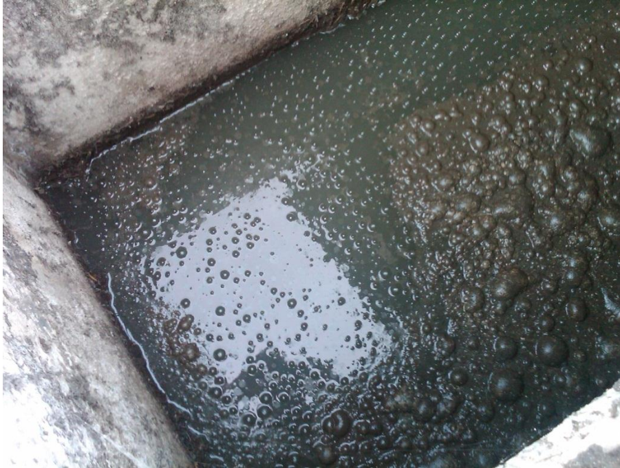
Imagen D.17. Burbujeo por actividad microbiana (EM•1®) en el tanque sedimentador
