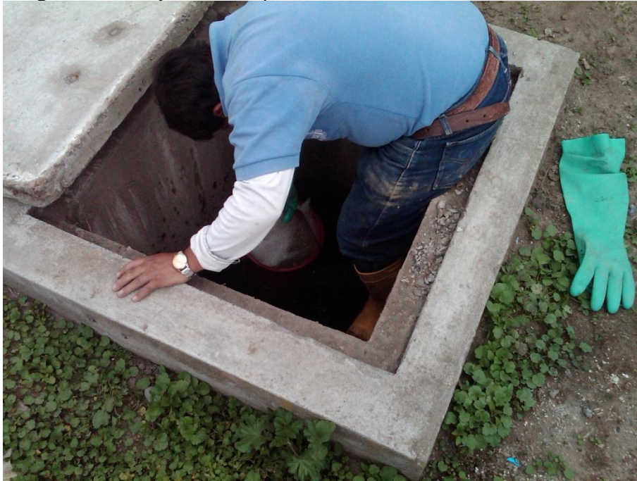
Imagen D.21. Caja de aforo para determinación de caudal de entrada.
