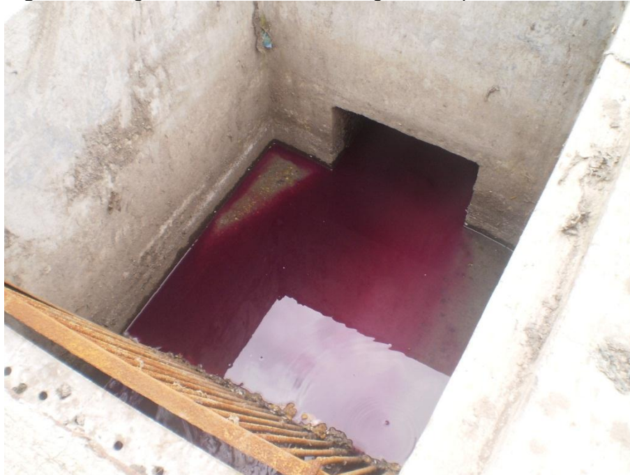
Imagen D.20. Agua contaminada en su llegada a la planta de tratamiento
