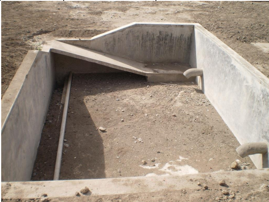
Imagen D.10. Estanque de secado de lodos planta de tratamiento Puerto Arturo
