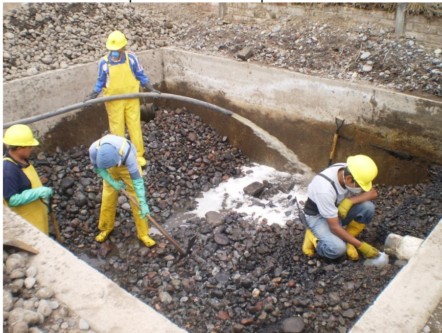
Imagen D.12. Lavado de piedras en los filtros planta de tratamiento Puerto Arturo
