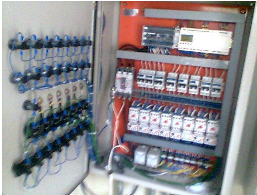
Imagen 11. Panel principal de control para el funcionamiento de los sistemas automáticos de la planta
