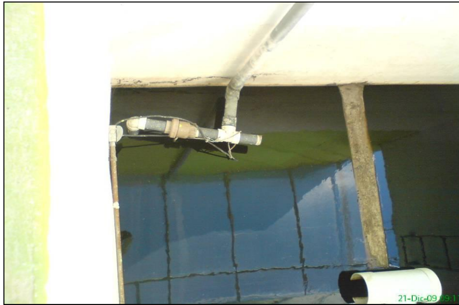
Figura 3: Problema de desconexión de la tubería en pozo de bombas 1.
