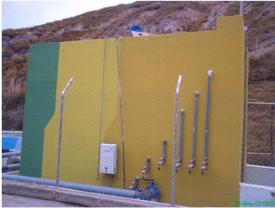
Imagen 40. Válvulas de muestreo de lixiviado del UASB a 6 diferentes alturas.
