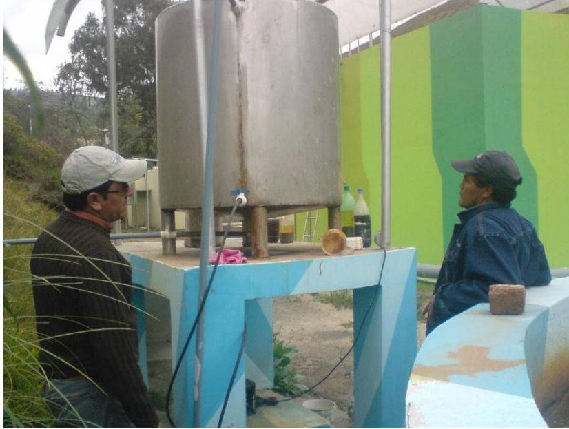
Imagen 7. Tanque del coagulante
