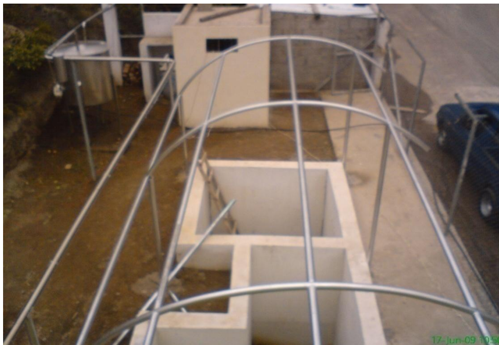
Imagen 13. Trabajo realizado para la instalación de la cubierta en el trayecto de ingreso del lixiviado crudo.
