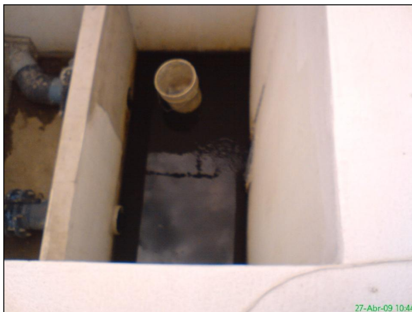
Imagen 1. Tanque desarenador, válvula a pozo bombas 1 y válvula a bypas
