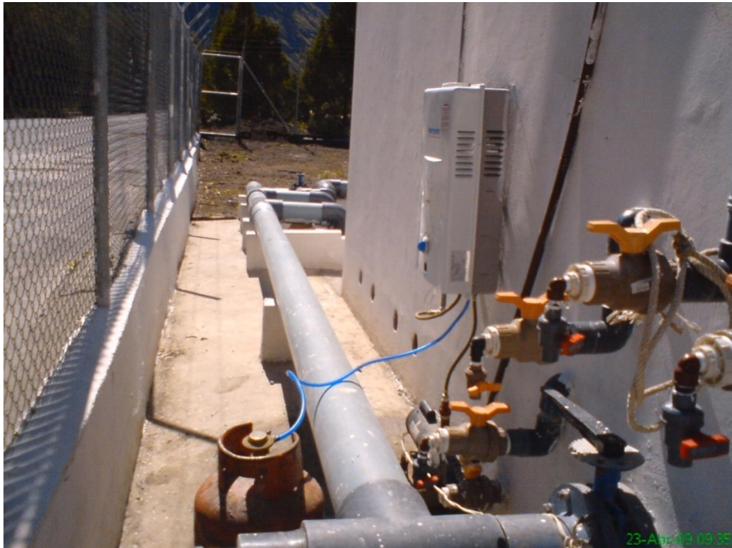
Imagen 19. Sistema de calentamiento provisional que se instaló para incrementar y mantener la temperatura del lixiviado en el interior del reactor UASB.
