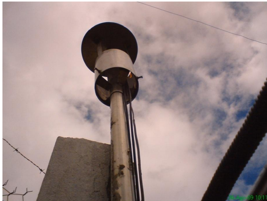
Imagen 10. Quemador de biogás funcionando
