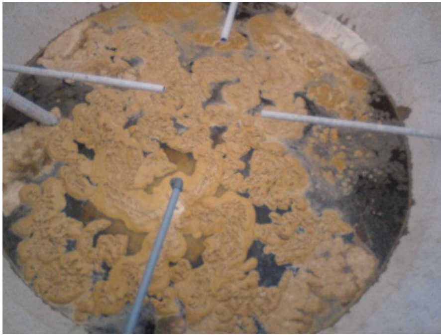
Imagen 38. Formación de flócs en el tanque clarificador durante la dosificación con sulfato de aluminio.
