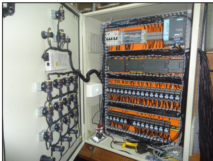
Fig. 128. Elementos en el interior del Tablero de Control
