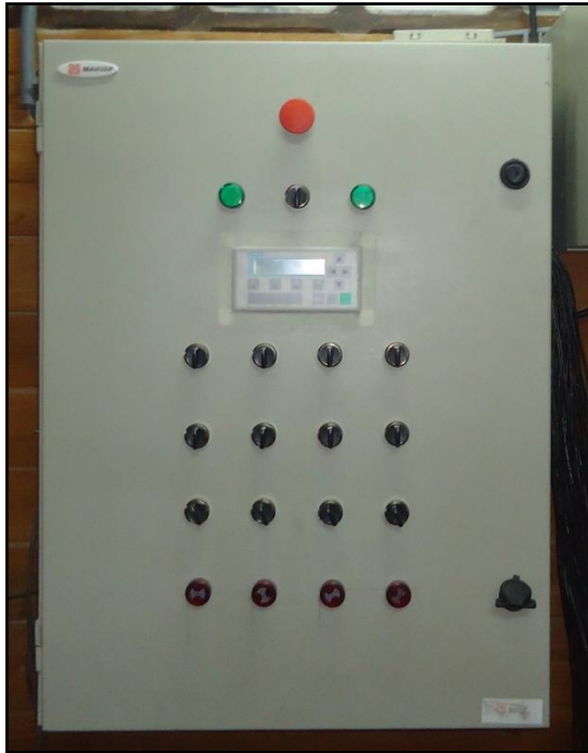
Fig. 127. Elementos en el exterior del Tablero de Control
