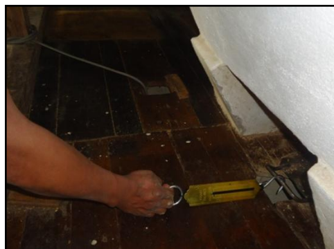
Fig. 12. Fuerza realizada para abrir la compuerta
