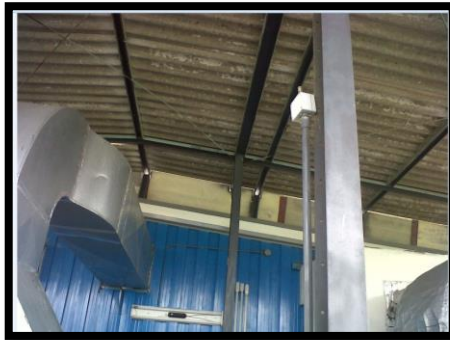
Figura N° 6. 35: Sensor de temperatura y humedad exterior de la sala Fuente: Investigador
