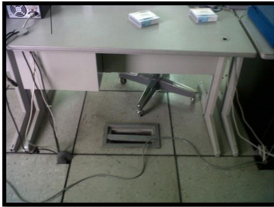
Figura N° 4. 2: Rejilla ubicada en el piso en falso Fuente: Investigador
