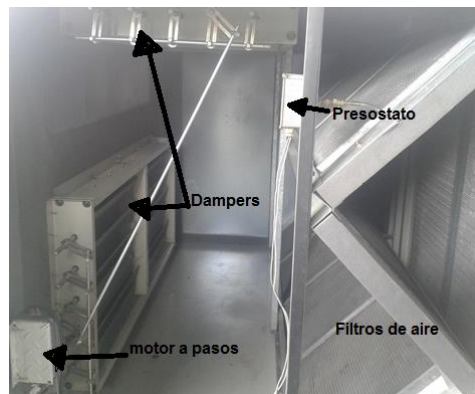
Figura N° 4. 8: Dampers, presostato, motor a pasos, filtros Fuente: Investigador
