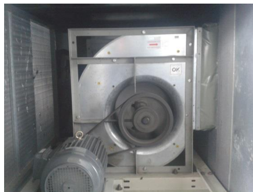
Figura N° 4. 7: Ventilador Fuente: Investigador
