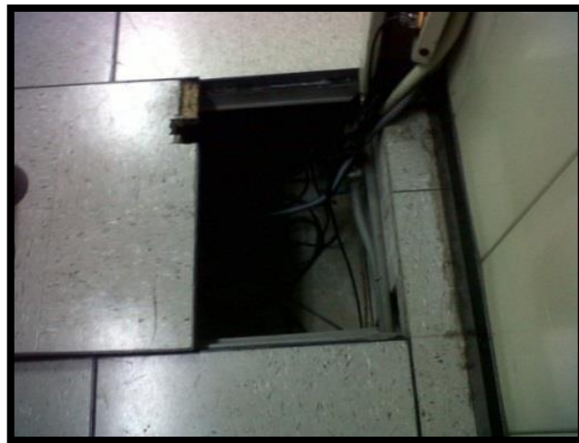
Figura N° 4. 1: Suministró de aire mediante el piso en falso
