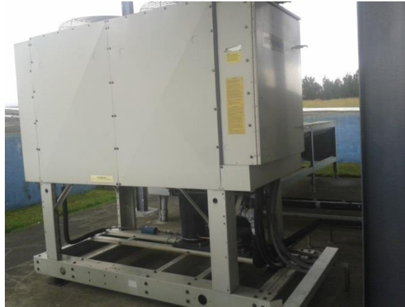
Figura N° 4. 9: Ubicación de la unidad condensadora de aire Fuente: Investigador
