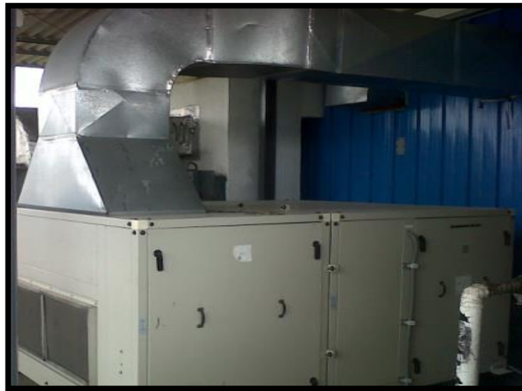
Figura N° 6. 8: Ductos de aire Fuente: Investigador
