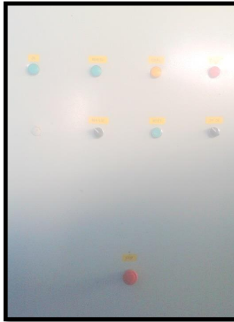
Figura N° 6. 33: Vista del tablero de control parte frontal Fuente: Investigador
