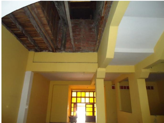
Fotografía N°- 9 Auditorio, Mal estado de techos Fuente: Toma fotográfica por el investigador
