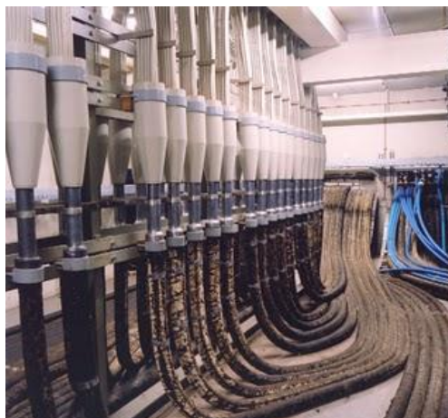
Figura 2.5 Galería de Cables [5]
