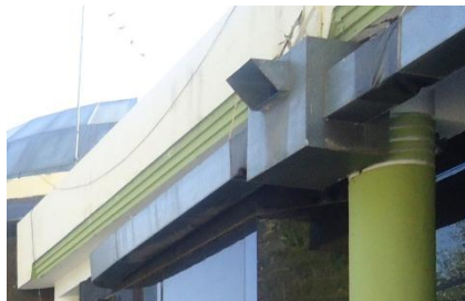
Fig. 96: Ventilador exterior mediante ductos Elaborado por: Jorge Altamirano
