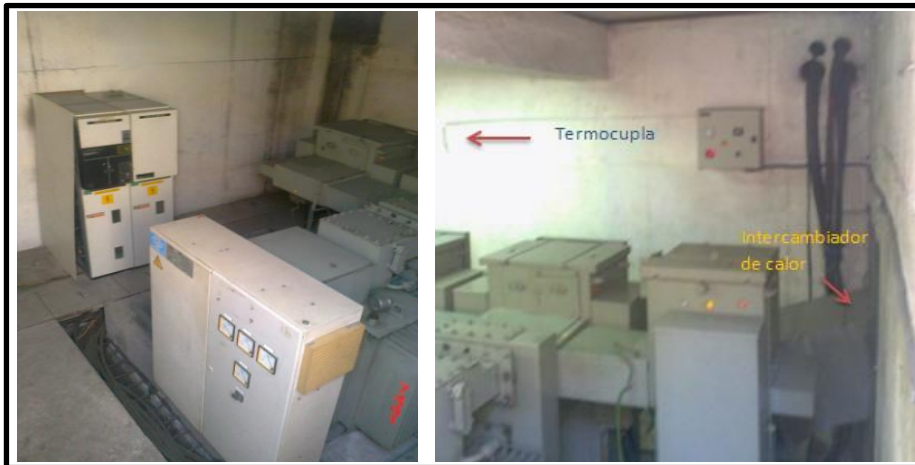
Gráfico 41. Descripción de Cámaras de Transformación eléctrica Subterráneas Fuente: Cámaras de Transformación Eléctrica EEASA.
