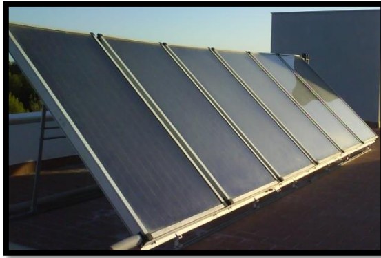
FIGURA 2-9 Colectores Solares de polipropileno
