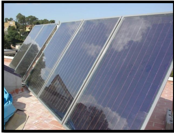
FIGURA 2-11 Colectores Solares de polipropileno
