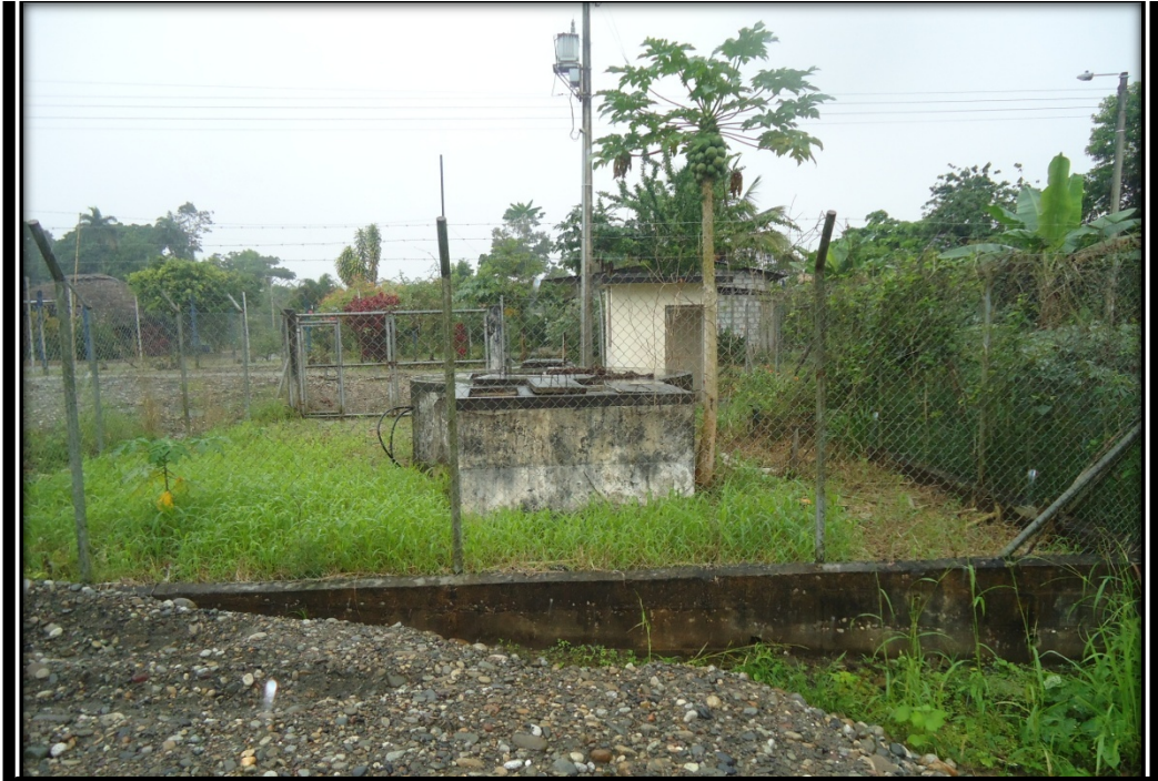
ACTUAL TANQUE DE RECOLECCIÓN DE AGUAS SERVIDAS EN EL BARRIO CENTRAL DE LA PARROQUIA PACAYACU.
