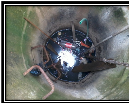
ESTANCAMIENTOS EN POZOS
