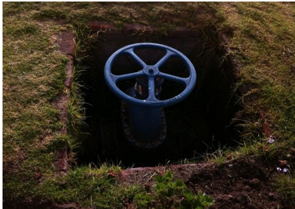
Figura 50 Llave de Paso Agua del Río Ambato
