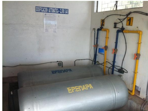
Figura 49 Proceso de Cloración
