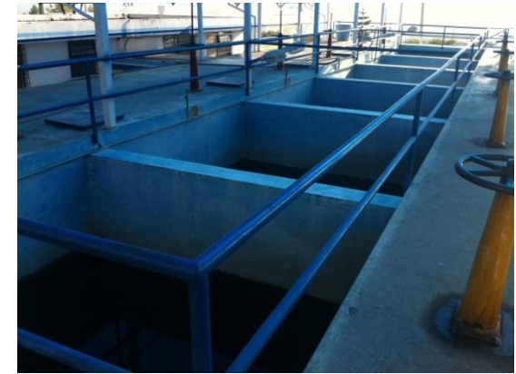
Figura 51 Proceso de Filtración
