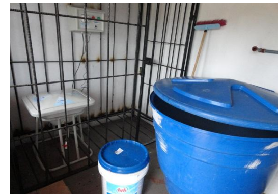
Figura 56 Estación de Cloración ATANSE
