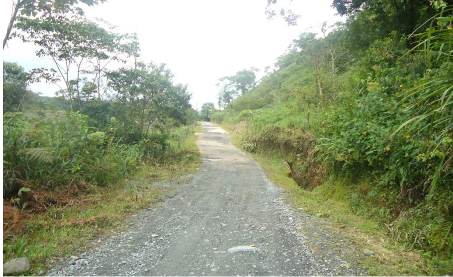
Grafico N° 4.14: Condiciones de la vía Tramo: Km 1+500 - Km 2+000.
