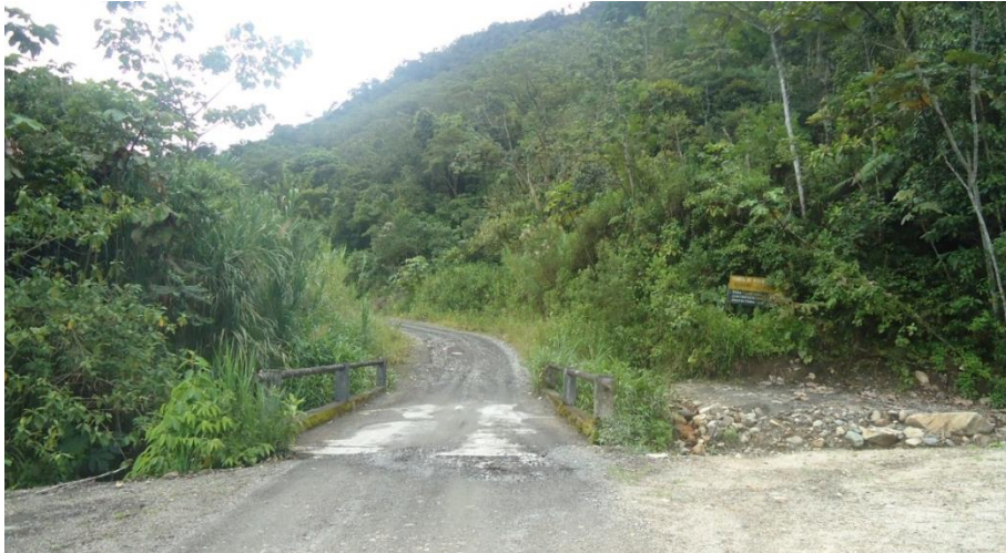
Grafico N° 4.11: Condiciones de la vía Tramo: Km 0+000 - Km 0+500.
