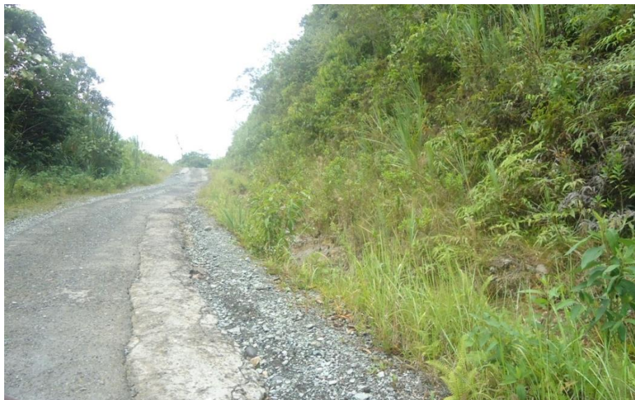
Grafico N° 4.12: Condiciones de la vía Tramo: Km 0+500 - Km 1+000.
