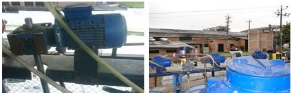
FIGURA 4 - 87: Colocación de moto-reductores incorrecta - Proyecto PTAR
