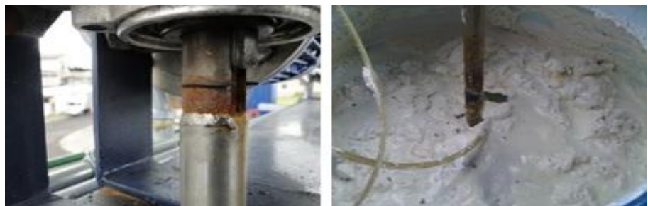
FIGURA 4 - 88: Sistemas de Agitación Corrosivos a los Químicos - Proyecto PTAR
