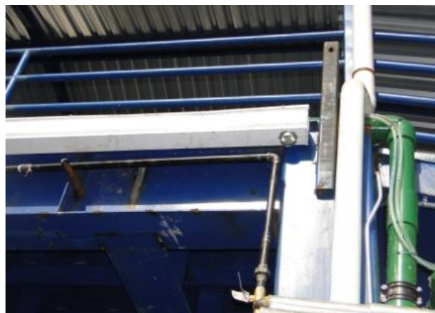
FIGURA 4 - 97: Bajantes de PVC - Proyecto PTAR
