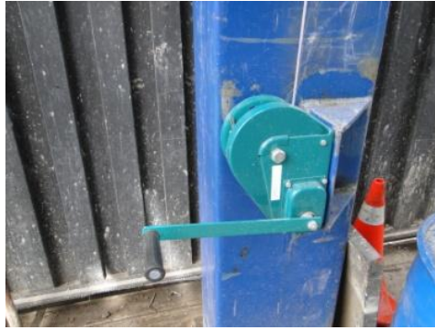
FIGURA 4 - 60: Sistema de Apertura de Tolva de Lodos – Proyecto PTAR
