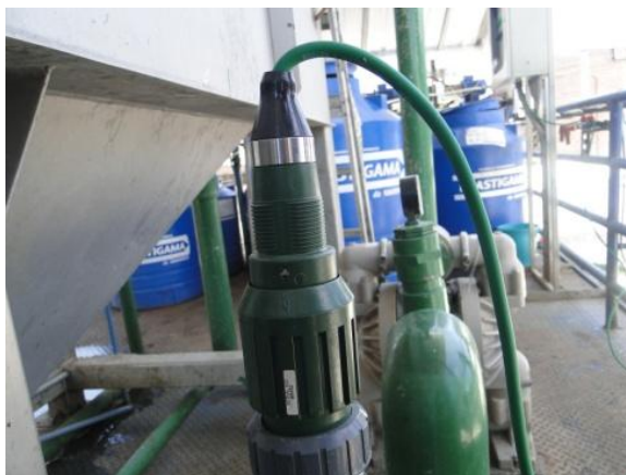
FIGURA 4 - 105: Colocación bypass para pH metro - Proyecto PTAR
