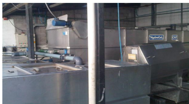
FIGURA 4 - 79: Interconexión entre tanques y filtros - Proyecto PTAR
