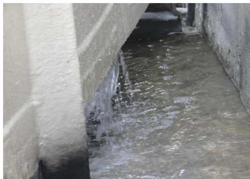
FIGURA 4 - 108: Ruptura del tanque - Proyecto PTAR
