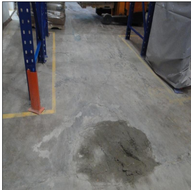
FIGURA 4 - 32: Daños en piso Bodegas
