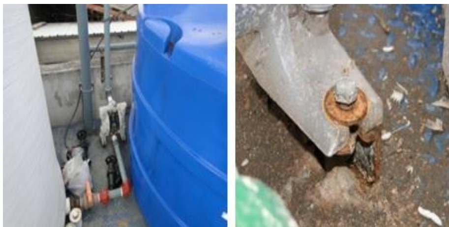
FIGURA 4 - 84: Bombas Dosificadoras Mal Instaladas - Proyecto PTAR
