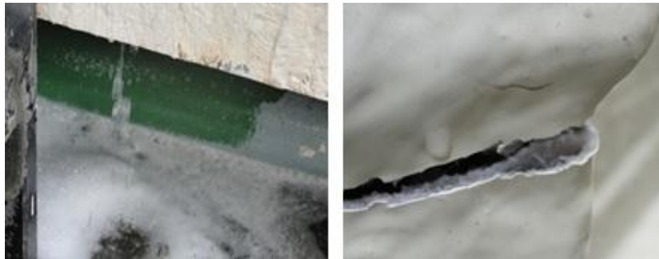
FIGURA 4 - 109: Ruptura tanque segunda ocasión - Proyecto PTAR
