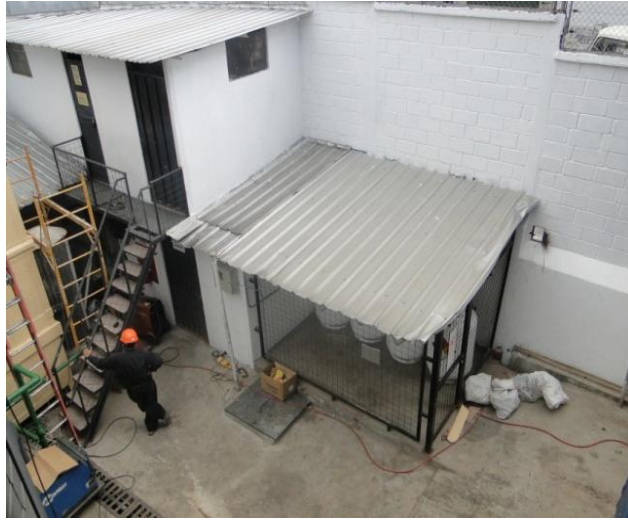
FIGURA 4 - 28: Derrocamiento Bodegas - Sistema Gas Centralizado
