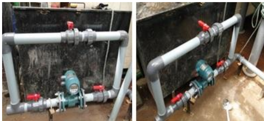
FIGURA 4 - 90: Instalación Errónea de Flujo-metros - Proyecto PTAR
