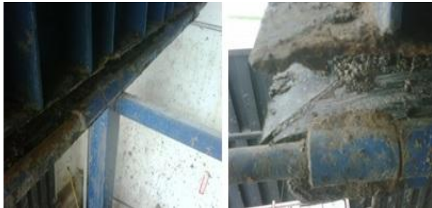
FIGURA 4 - 89: Sistema de Bisagra de Compuerta de Tolva Inestable - Proyecto PTAR
