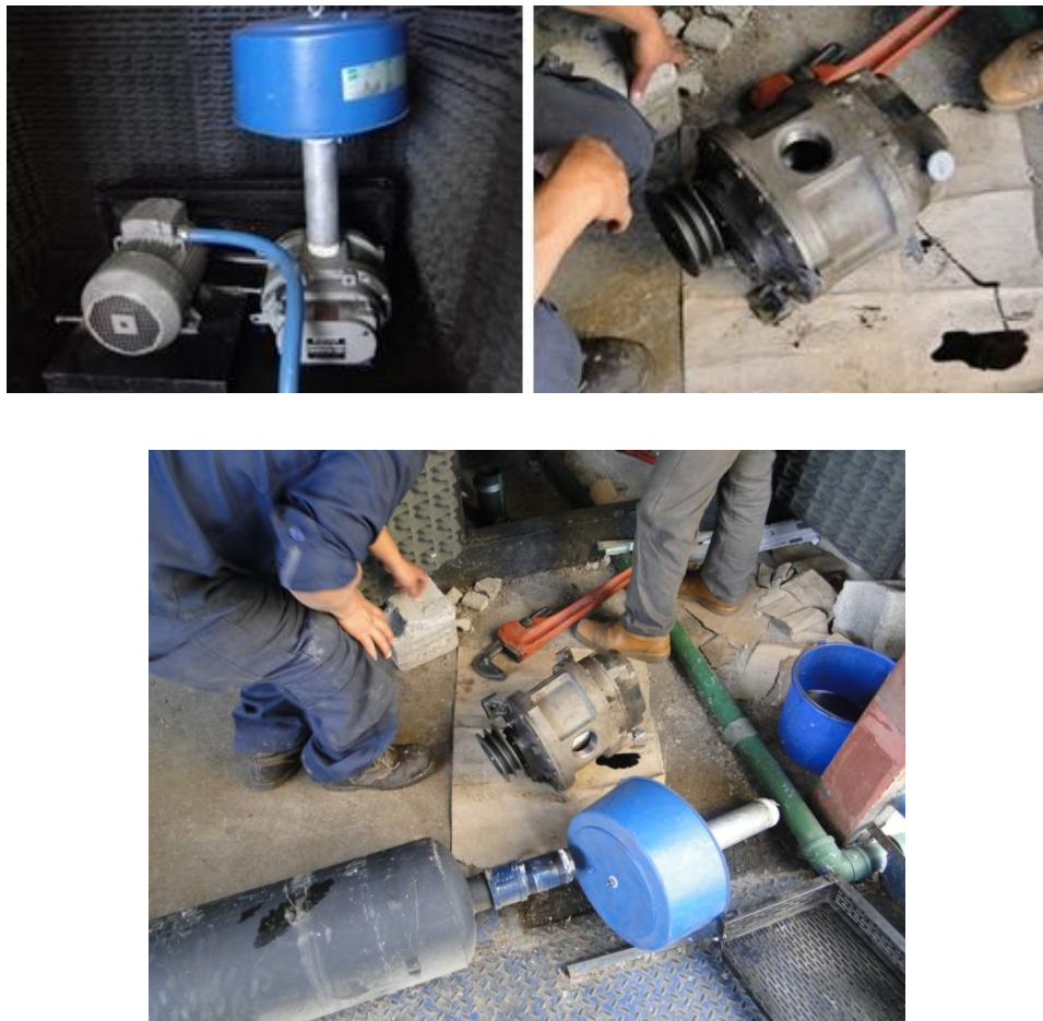
FIGURA 4 - 113: Fallo del Soplador y Cambio - Proyecto PTAR
