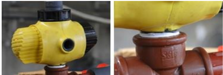
FIGURA 4 - 86: Irresponsabilidad en el manejo de válvulas de dosificación - Proyecto PTAR
