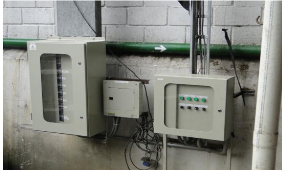
FIGURA 4 - 75: Tablero Eléctrico Nuevo – Proyecto PTAR
