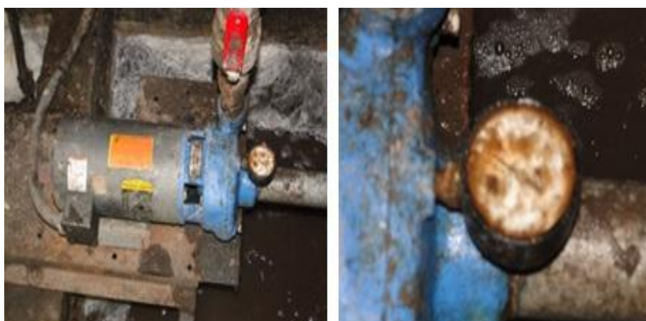
FIGURA 4 - 85: Bombas Centrífugas inestables - Proyecto PTAR
