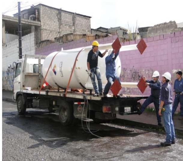
FIGURA 4 - 29: Llegada del tanque de Gas - Sistema Gas Centralizado
