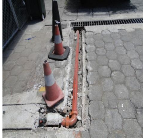
FIGURA 4 - 19: Acabados de Instalación de las Tuberías – Sistema contra incendios
