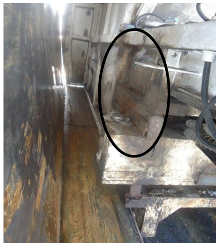
Rotura, fractura y daño de la estructura
