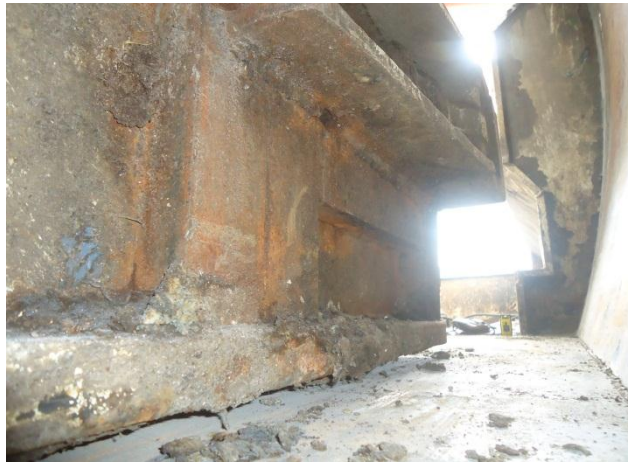
Corrosión en la estructura del compactador
