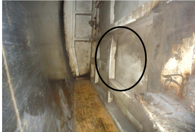
Torcedura y daño en la geometría de la estructura
