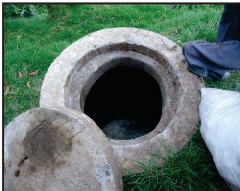
Pozos de Revisión Existentes
