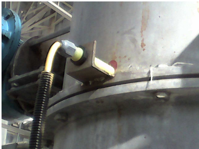
Ilustración 121: Instalación de Sensores de Costura.
