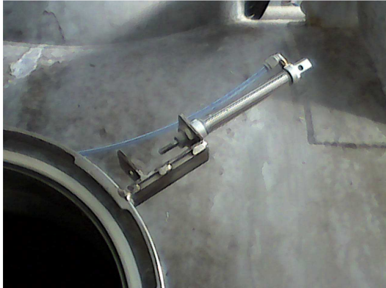
Ilustración 122: Instalación de Cilindros Neumáticos de Seguridad en Escotillas.
