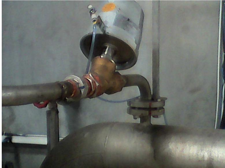
Ilustración 118: Instalación de Válvula de Llenado de Cuba con Recirculado.
