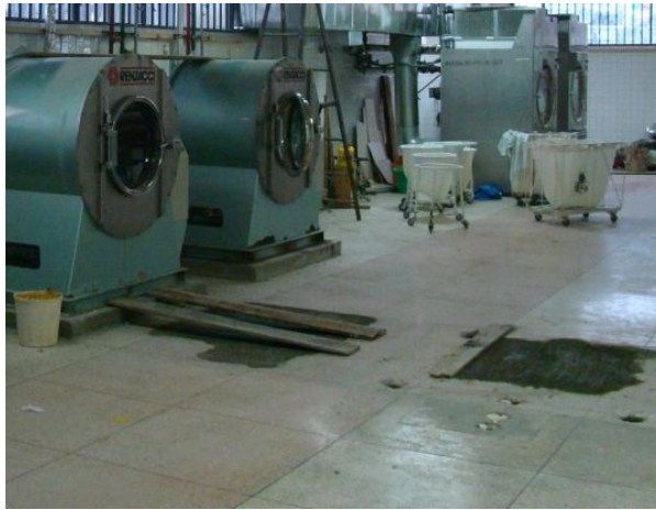
Fotografía No. 4: Desorden en pasillos de la planta.
