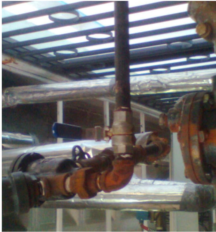
Fotografía No. 10: Tubería de vapor desgastada y sin el aislamiento adecuado.
