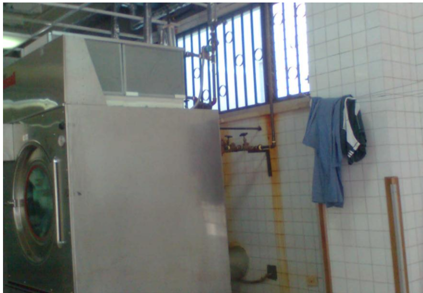
Fotografía No. 2: Desorden y suciedad en pasadizos de máquinas.
