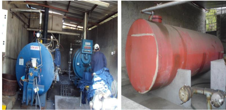
Figura 3.3: Área de caldero
