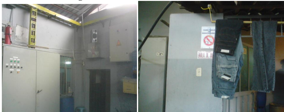
Figura 3.4: Señalización mal ubicada
