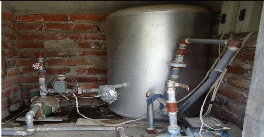
Bomba y vaso de expansión
