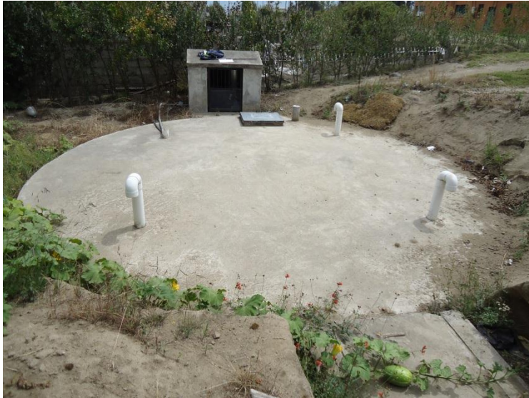
Cisterna de abastecimiento de agua del hospital.
