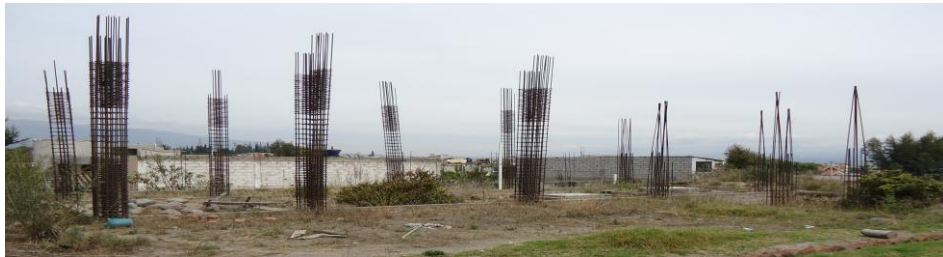
Sala de máquinas.
