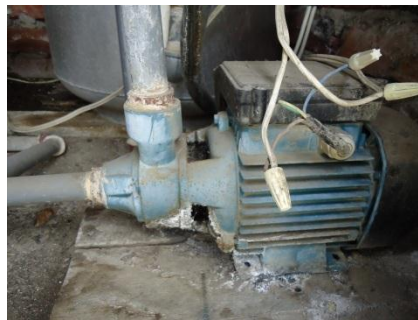
Bomba de abastecimiento de agua a tanque elevado del bloque principal.
