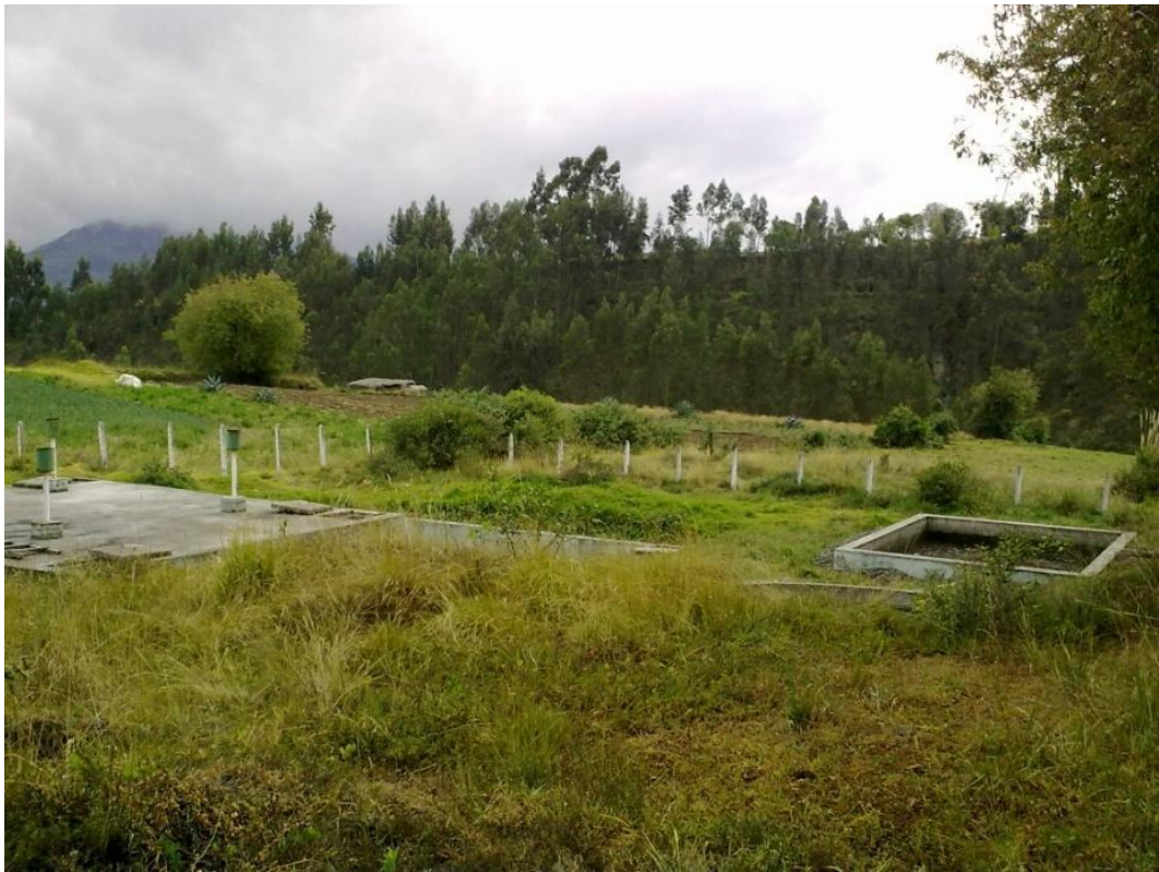
Planta de tratamiento punto de conexión del sistema de evacuación de las aguas recogidas en el sector Yanahurco.
