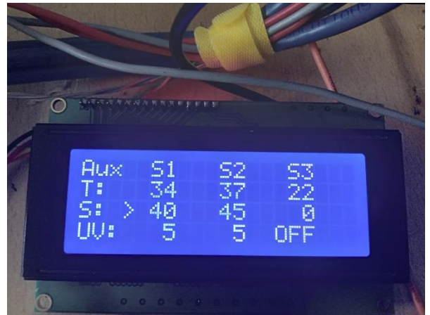
(b) Ventana sistema de control
