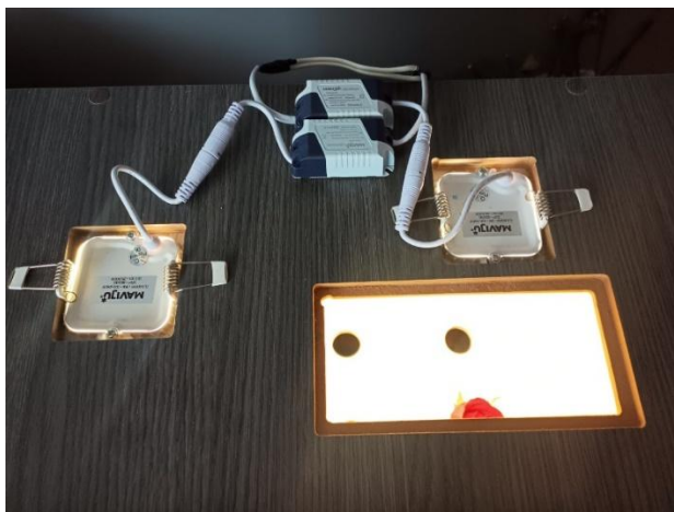
Figura 20. Sistema de iluminación en el prototipo
