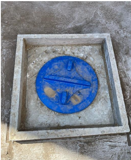
Figura 24. Suciedad en parte externa de cisterna
