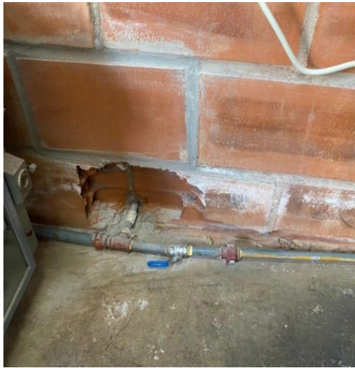
Figura 30. Grietas en departamento de calidad
