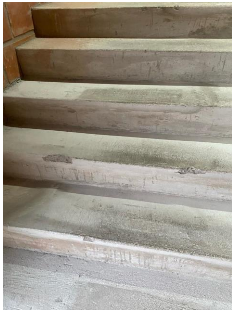
Figura 40. Grietas en gradas
