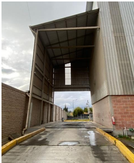
Figura 16. Falta cortinas de plástico en recepción para evitar el ingreso de aves, polvo.
