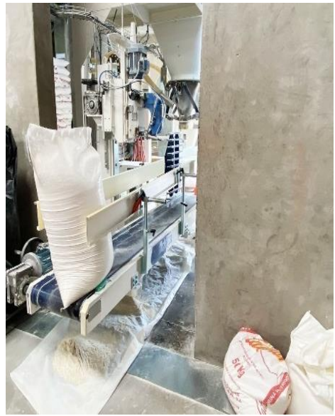
Figura 37. Falta forma cóncava en uniones de piso y pared en ensacado
