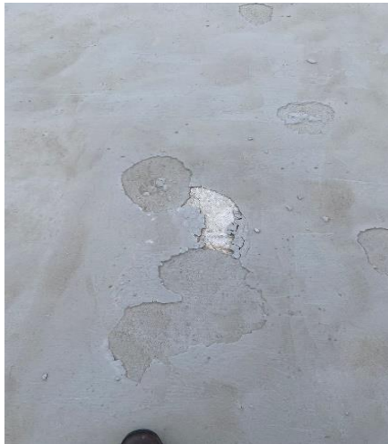
Figura 26. Grietas en terraza
