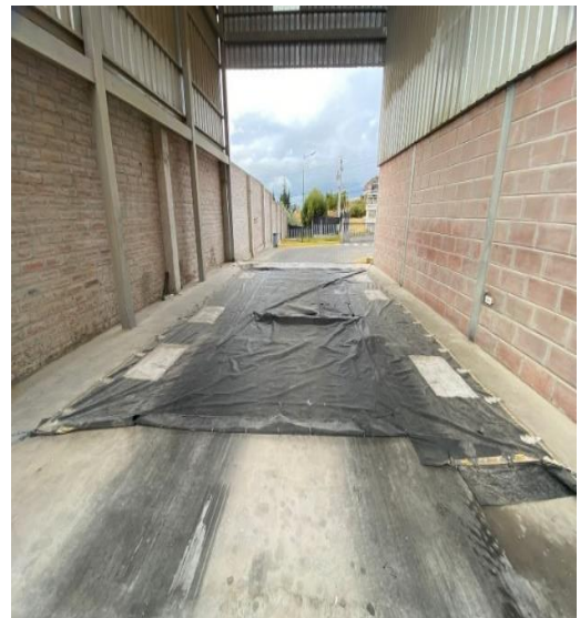
Figura 17. Suciedad en piso de recepción y paredes.
