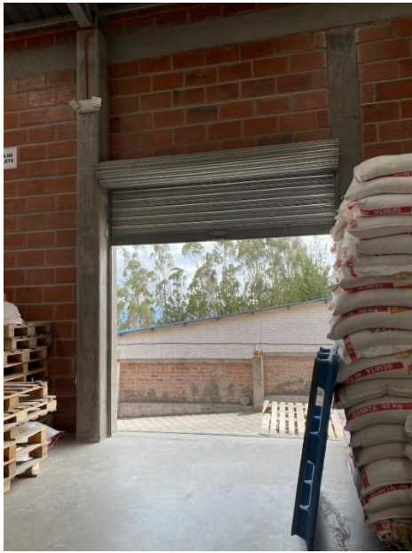
Figura 18. Falta maquinaria de ventilación ya que se abre lanfor para ventilar (bodega).
