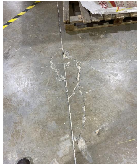
Figura 25. Grietas en piso de bodega
