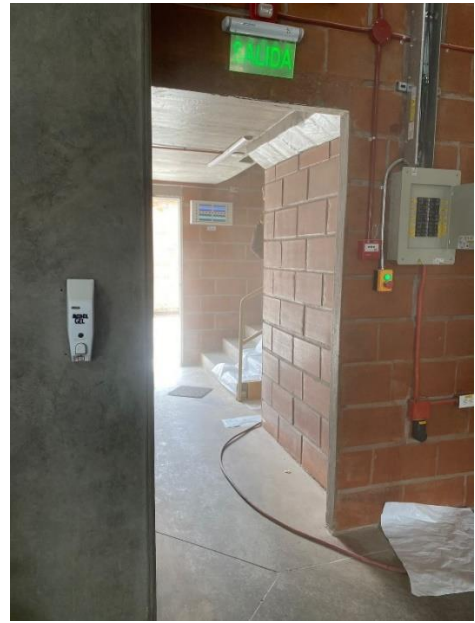
Figura 19. Falta cortinas de plástico para evitar contaminación por polvo. (entrada externa de recepción hacia producción).
