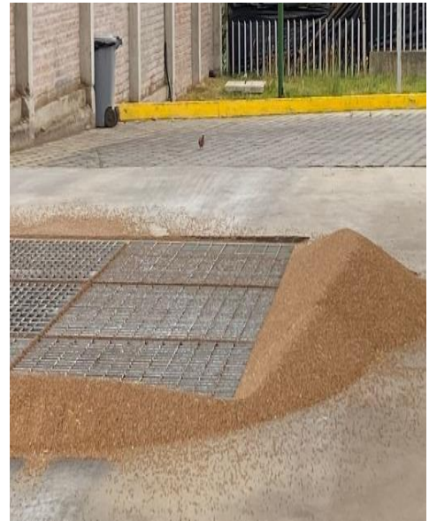
Figura 43. No se evidencia cortinas de plástico en área de recepción. (Contaminación por eses de paloma en materia prima)
