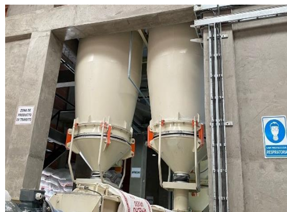
Figura 68. Señalética en área de ensacado
