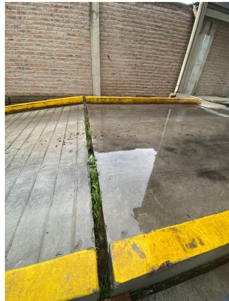
Figura 41. Falta protección y limpieza en drenaje de recepción.
