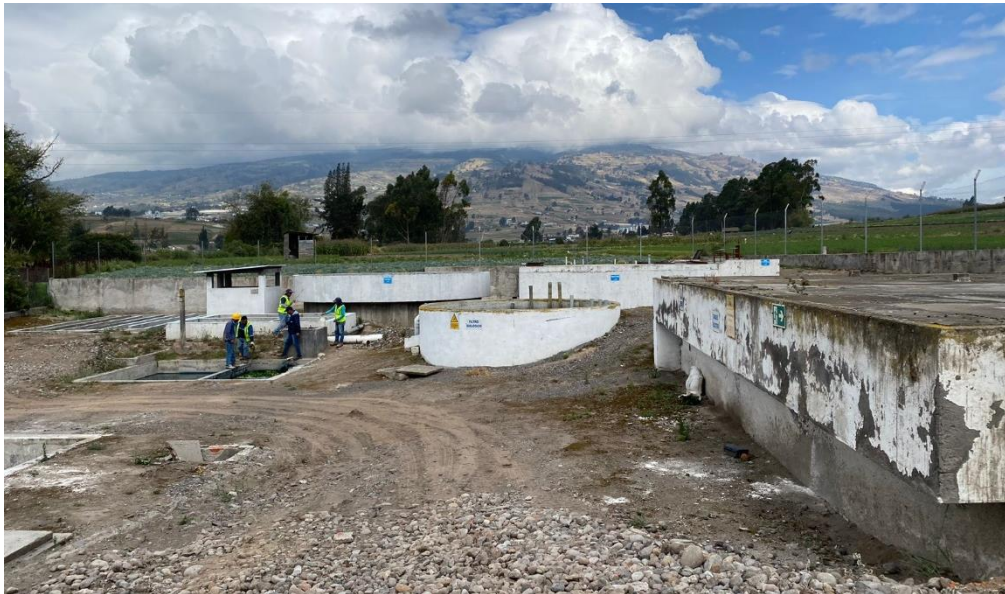
Figura 3. Planta de Tratamiento de Aguas Residuales Puerto Arturo (EP-EMAPA-A).
