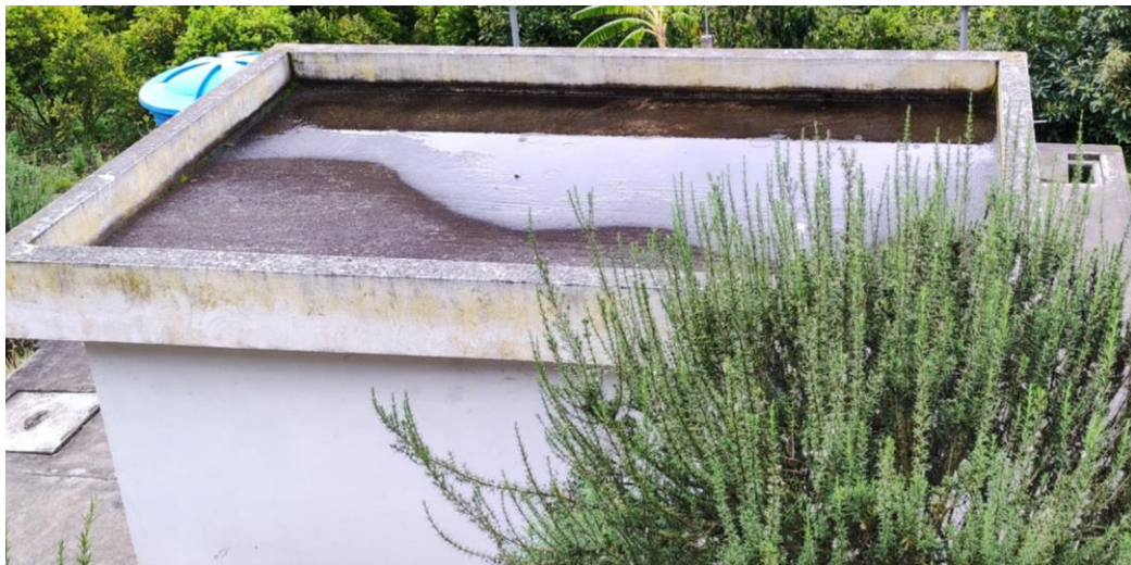
Figura 14. Acumulación de agua en la cubierta de la caseta del operador. Fuente: Autor
