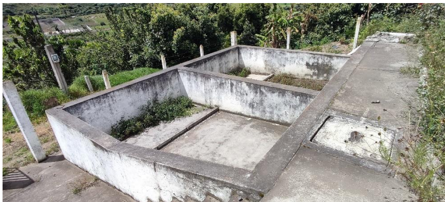
Figura 58. Vista lateral del lecho de secado de lodos se denota la maleza a su alrededor. Fuente: Autor
