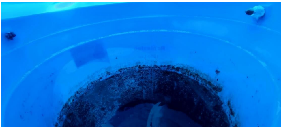
Figura 10. Acumulación de suciedad en el tanque clorador.
