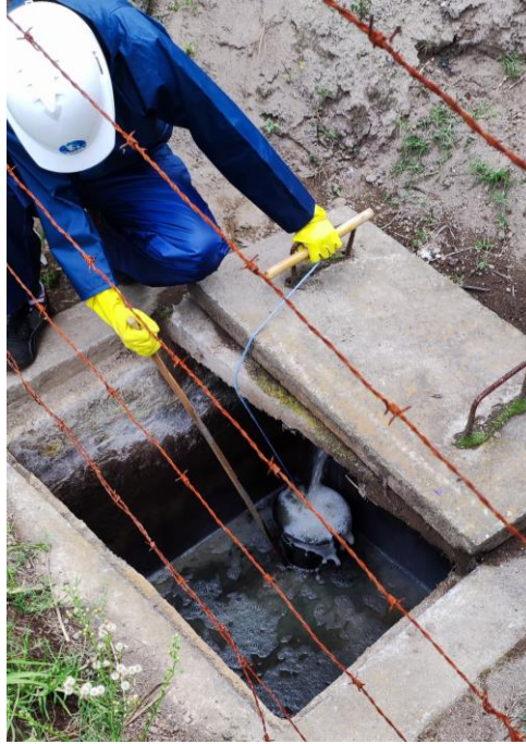
Figura 50. Medición de caudales mediante el método volumétrico en la caja de revisión de salida de agua tratada. Fuente: Autor
