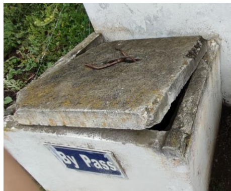
Figura 47. Deterioro en las tapas de hormigón armado de las cajas de válvulas y cajas de revisión. Fuente: Autor
