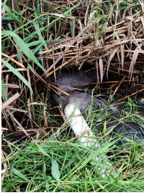
Figura 54. Descarga de aguas tratadas al cauce del Río Patate. Fuente: Autor
