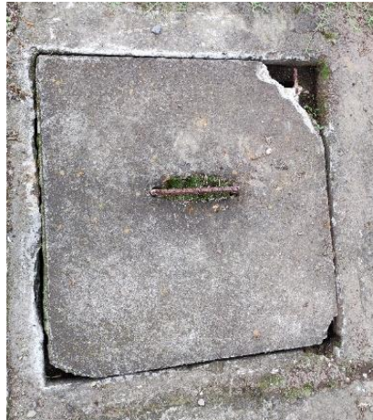
Figura 9. Deterioro en las tapas de hormigón armado.
