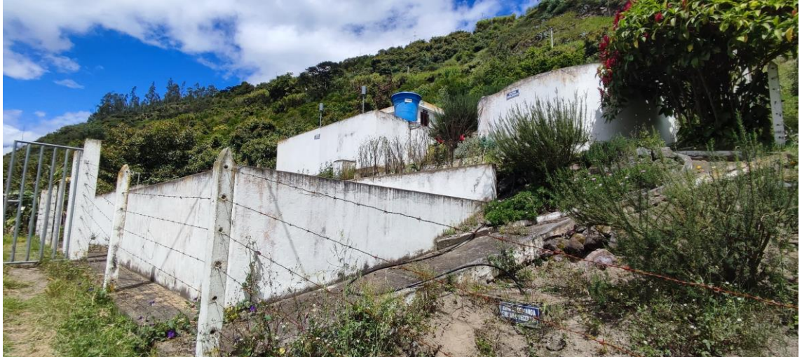
Figura 11. Deterioro de la pintura en las estructuras de la PTAR.
