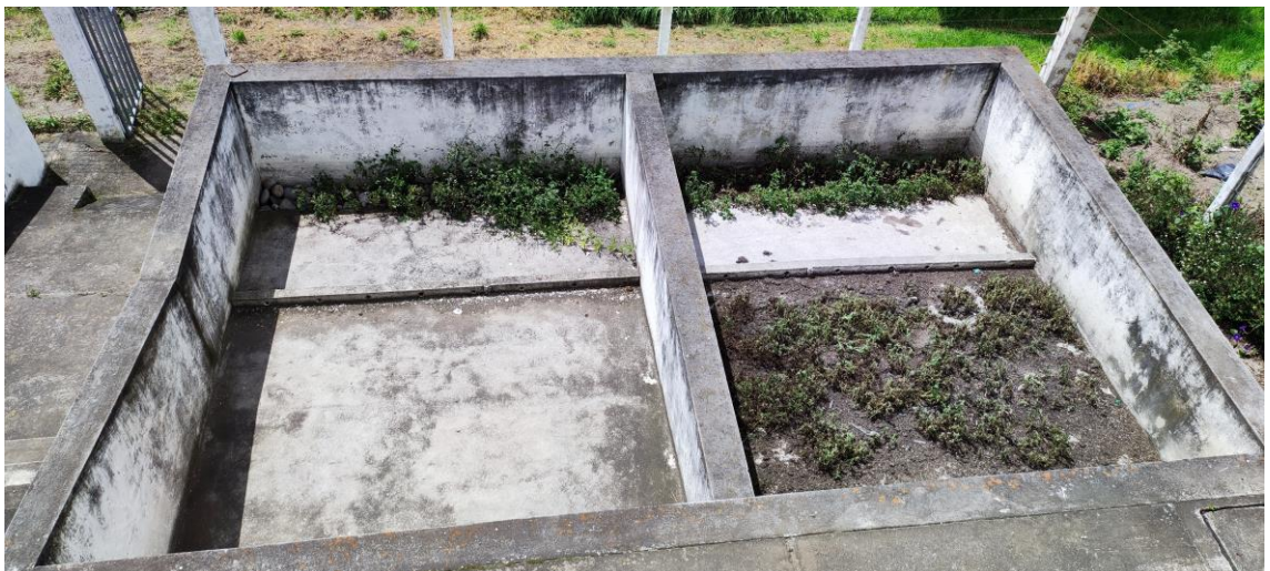
Figura 12. Evidencia de plantas en el medio filtrante del lecho de secado de lodos.
