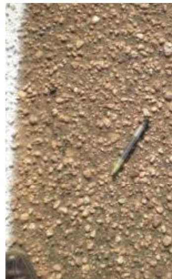
Gráfico 40: Meteorización /Desprendimiento de agregados severidad alta.
