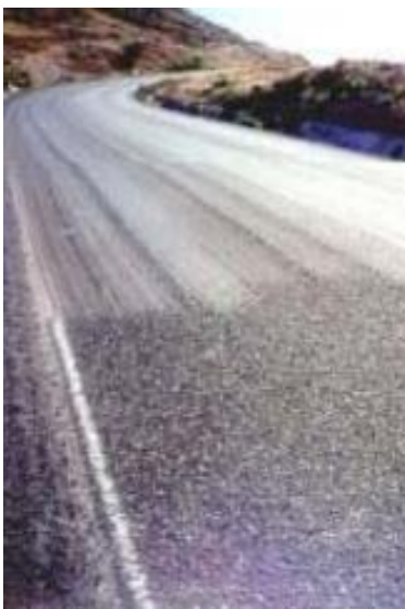
Gráfico 38: Meteorización /Desprendimiento de agregados severidad baja.
