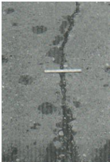
Gráfico 49: Agrietamiento transversal/ longitudinal severidad media.
