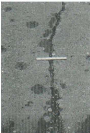
Gráfico 45: Agrietamiento transversal/ longitudinal severidad media.
