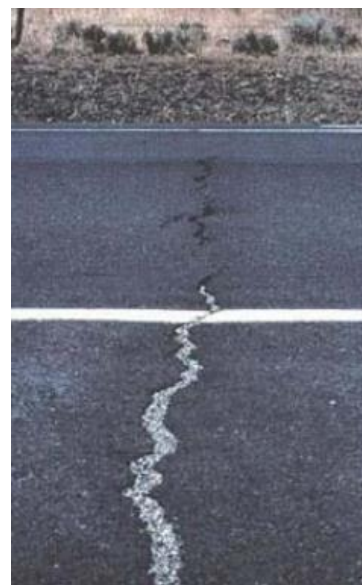
Gráfico 19: Grietas longitudinales y transversales severidad alta.
