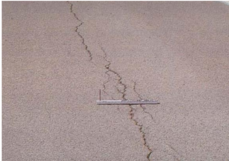
Gráfico 16: Grietas Longitudinales y Transversales.
