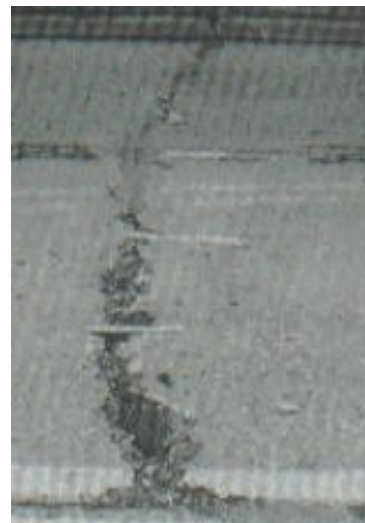
Gráfico 46: Agrietamiento transversal/ longitudinal severidad alta.
