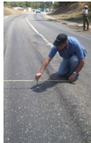
Gráfico 32: Ahuellamiento severidad alta.
