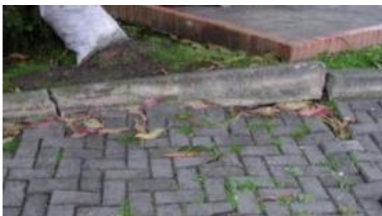
Gráfico 59: Fracturamiento de confinamientos externos.
