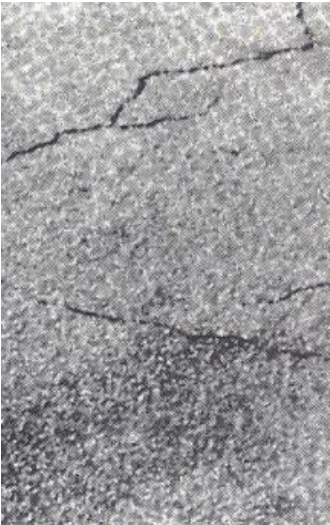
Gráfico 9: Agrietamiento en bloque severidad baja. Fuente: Identificación De Fallas En Pavimentos Y Técnicas De Reparación – Nevi-12 – 2016.
