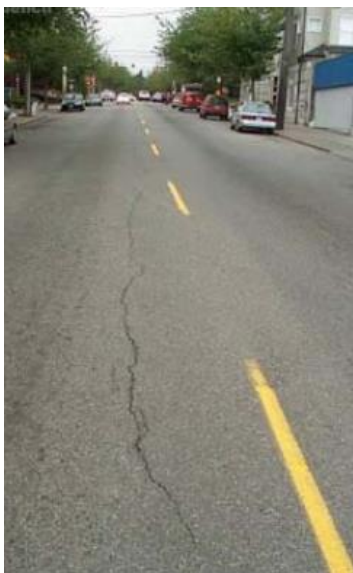
Gráfico 17: Grietas longitudinales y transversales severidad baja.
