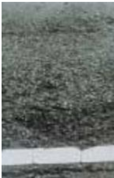
Gráfico 39: Meteorización /Desprendimiento de agregados severidad media.
