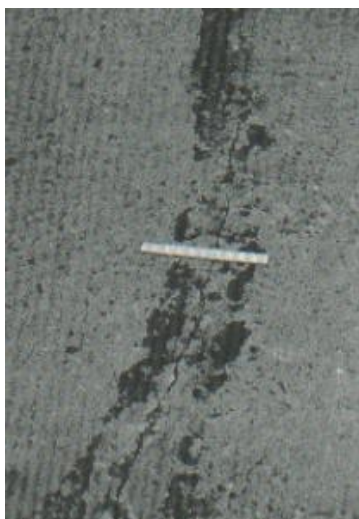
Gráfico 48: Agrietamiento transversal/ longitudinal severidad baja.
