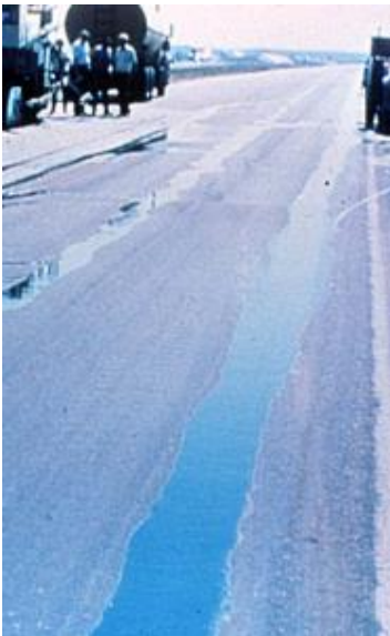
Gráfico 30: Ahuellamiento severidad baja.
