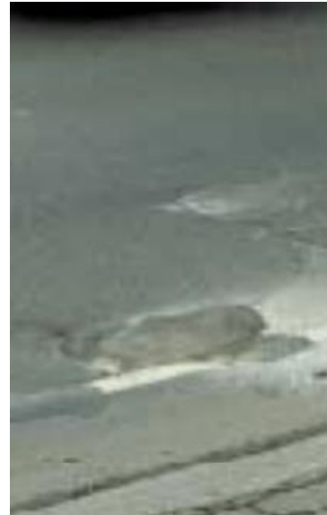
Gráfico 23: Parqueo y acometidas de servicio severidad alta.
