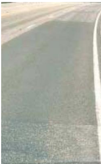
Gráfico 21: Parqueo y acometidas de servicio severidad baja.
