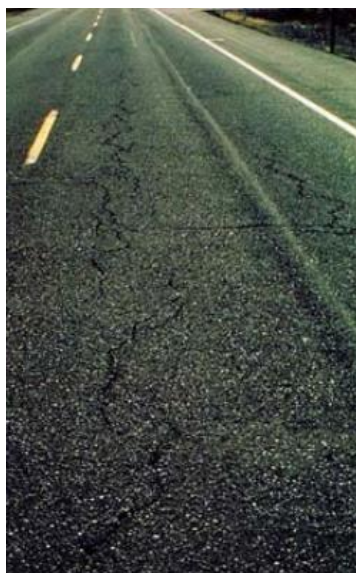
Gráfico 18: Grietas longitudinales y transversales severidad media.
