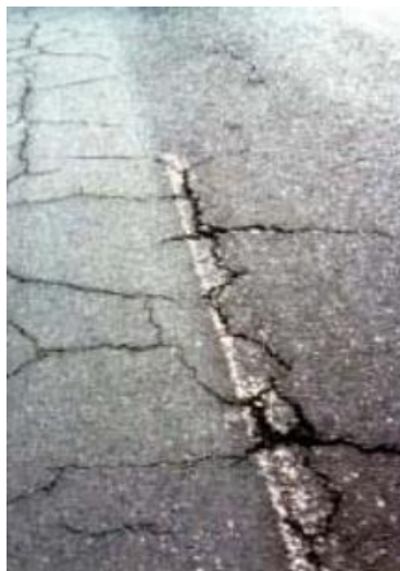
Gráfico 10: Agrietamiento en bloque severidad media. Fuente: Identificación De Fallas En Pavimentos Y Técnicas De Reparación – Nevi-12 – 2016.
