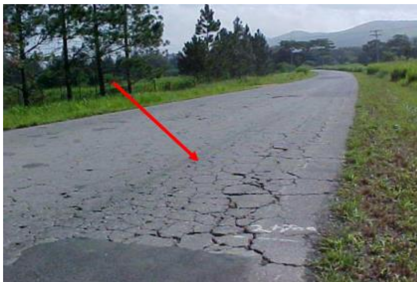
Gráfico 8: Falla Agrietamiento en Bloque.
