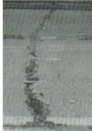
Gráfico 50: Agrietamiento transversal/ longitudinal severidad alta.
