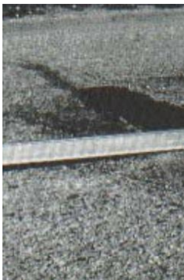
Gráfico 13: Abultamiento y hundimiento severidad baja.
