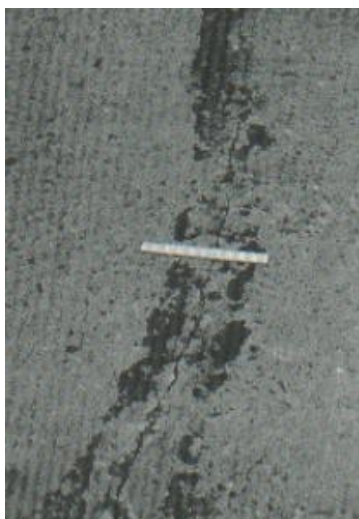
Gráfico 44: Agrietamiento transversal/ longitudinal severidad baja.
