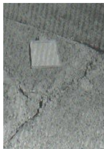
Gráfico 54: Agrietamiento de esquina severidad alta. Fuente: Pavement Condition Index (PCI) Para Pavimentos Asfálticos Y De Concreto En Carreteras - Vásquez Luis - 2002
