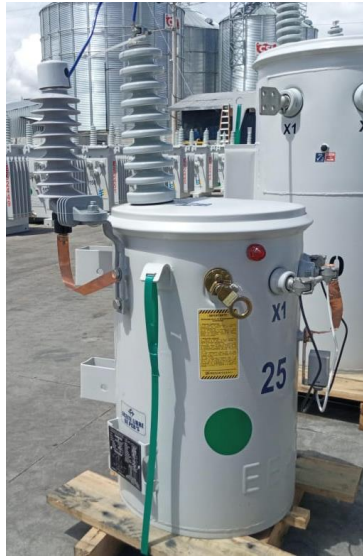
Figura 20. Transformador monofásico de 25 kVA.
