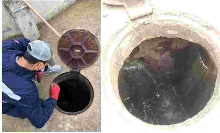
Figura 28. Pozo de salida en la PTAR
