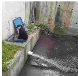
Mantenimiento del lecho de secado de lodos
