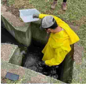
Medición de caudales de entrada en la PTAR
