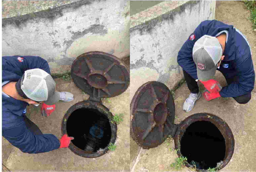
Figura 30. Pozos de revisión con válvulas de compuerta en la PTAR
