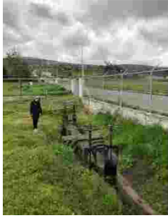
Desarenador en la PTAR
