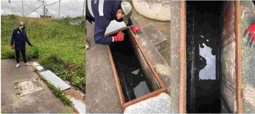
Figura 25. Reactor UASB (tratamiento primario)
