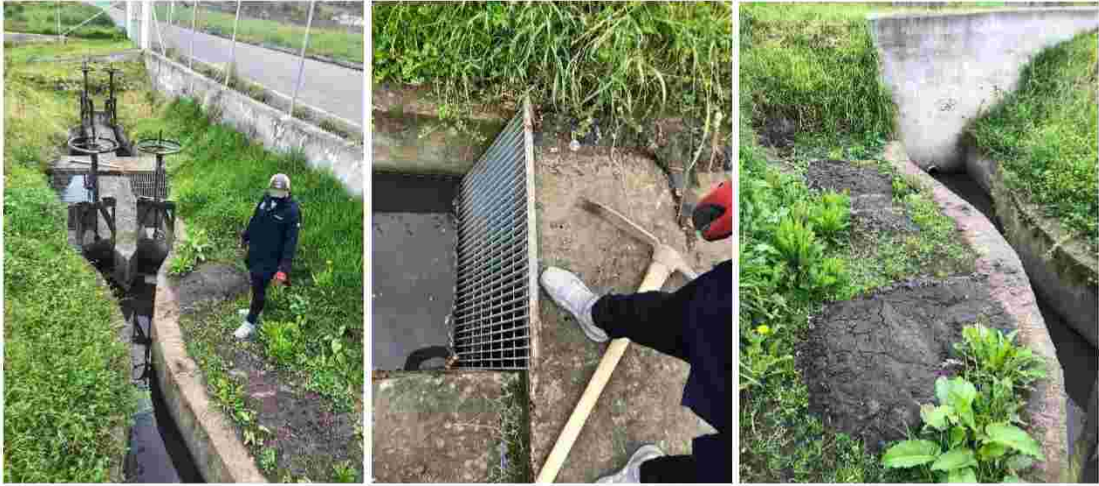
Figura 24. Desarenador y rejillas (tratamiento preliminar)
