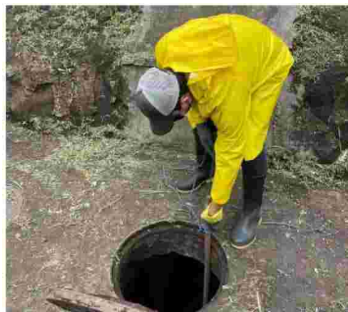
Figura 5. Medición de caudales de salida de la PTAR
