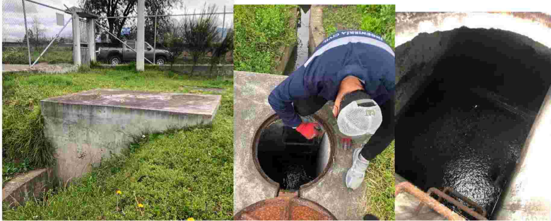
Figura 23. Pozo recolector de caudales
