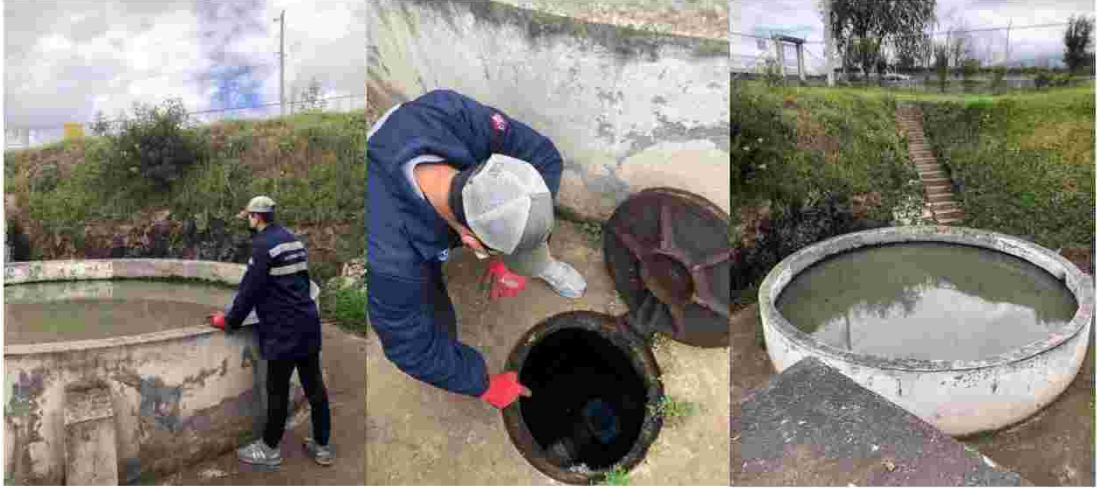
Figura 26. Filtro anaerobio de flujo ascendente (tratamiento secundario)
