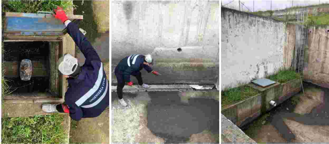
Figura 27. Lecho de secado de lodos
