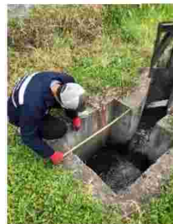
Medición de la unidades hidráulicas de la PTAR
