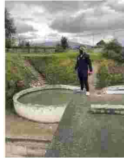
Reactor UASB en la PTAR
