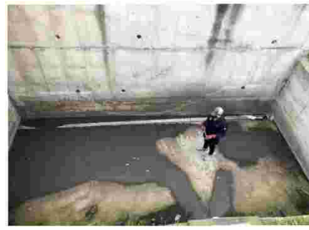
Lecho de secado de lodos en la PTAR
