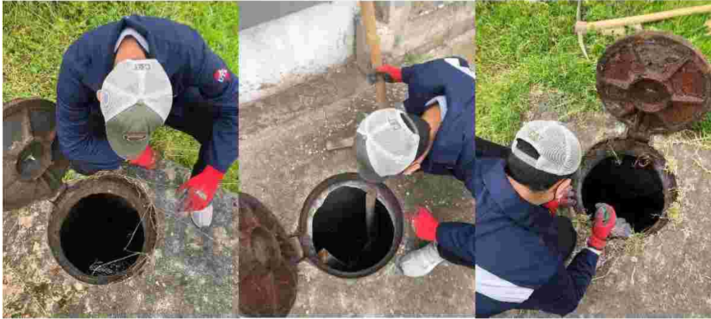
Figura 29. Pozos de revisión en la PTAR
