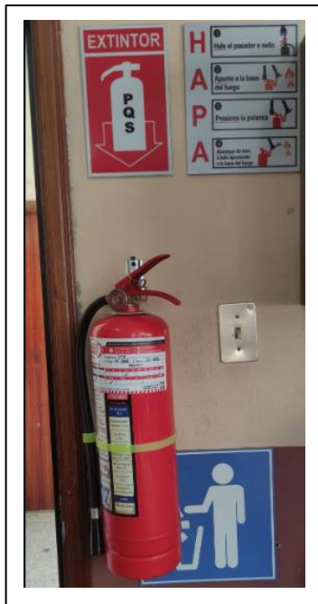
Figura 121. Ubicación actual del extintor contra incendios – LIM UTA
