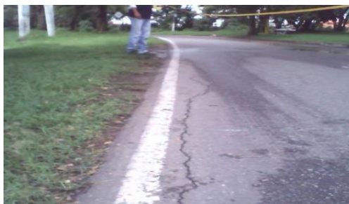
Figura 11. Grieta en borde (m)
