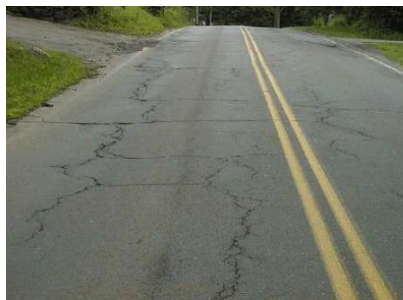
Figura 6. Agrietamiento en bloque (m2)
