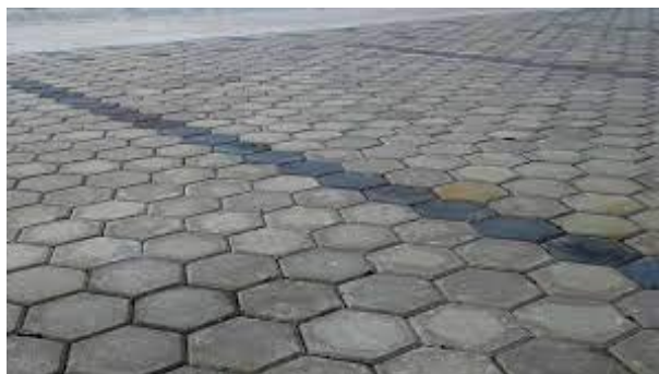
Figura 37. Juntas Abiertas (m2)
