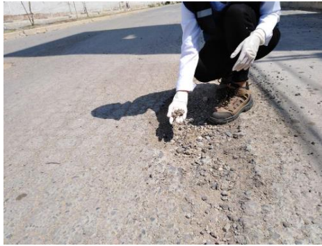
Figura 24. Desprendimiento de Agregado (m2)
