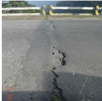
Figura 12. Grieta de reflexión de junta (m)
