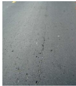
Figura 14. Grietas Longitudinales (m)
