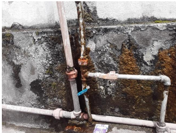
Figura 4: Tuberías sin señalización y en mal estado.
