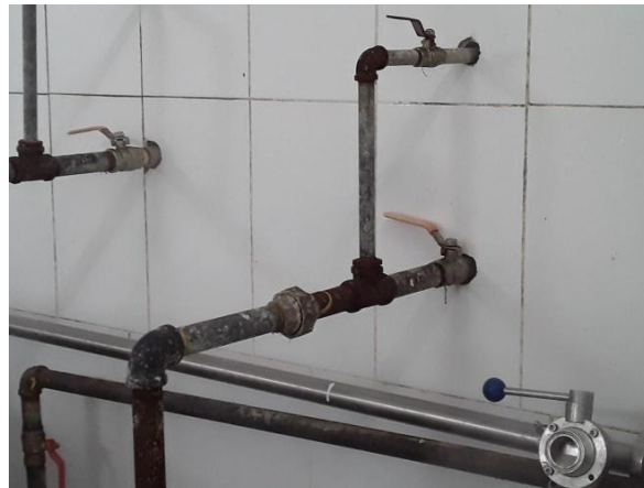
Figura 6: Tuberías con presencia de óxido.
