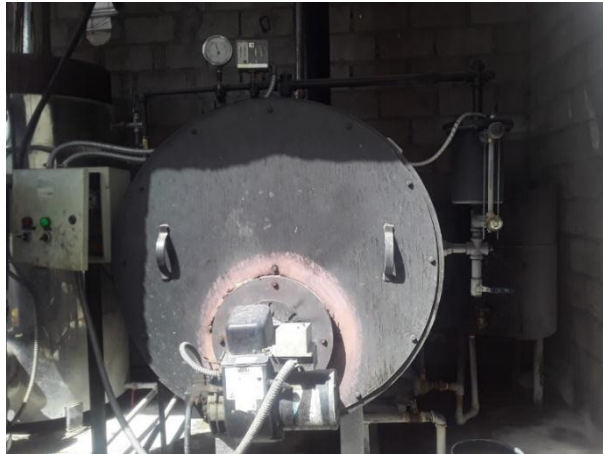
Figura 13: Cuarto exclusivo para maquinas, ordenado y limpio.
