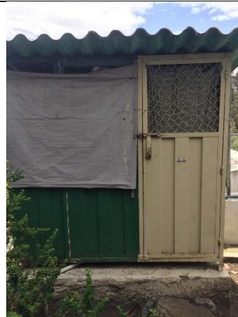
Fotografía 16: Caseta metálica de cloración.
