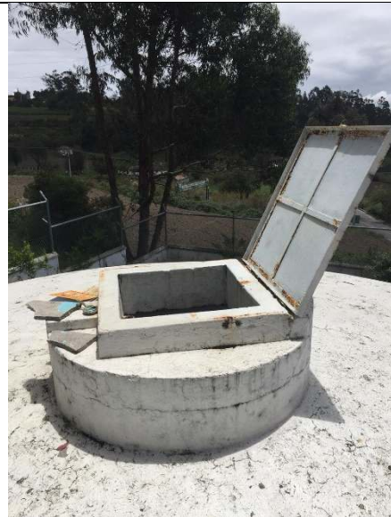
Fotografía 14: Boca de visita del tanque de almacenamiento.
