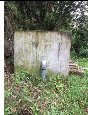
Fotografía 6: Tubería de salida del tanque desarenador hacia la PTAP.
