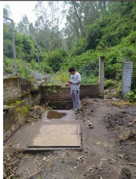
Fotografía 10: Identificación de la salida de las tuberías hacia el tanque desarenador
