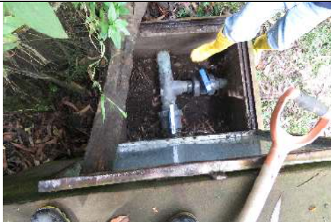
Fotografía 5: Unión de las tuberías provenientes de las 4 vertientes.
