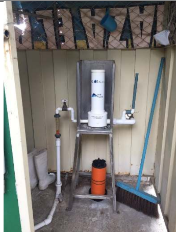
Fotografía 17: Equipo hipoclorador con briquetas de hipoclorito de calcio.
