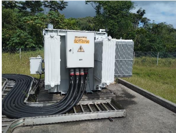
Figura 9 Sector del transformador.
