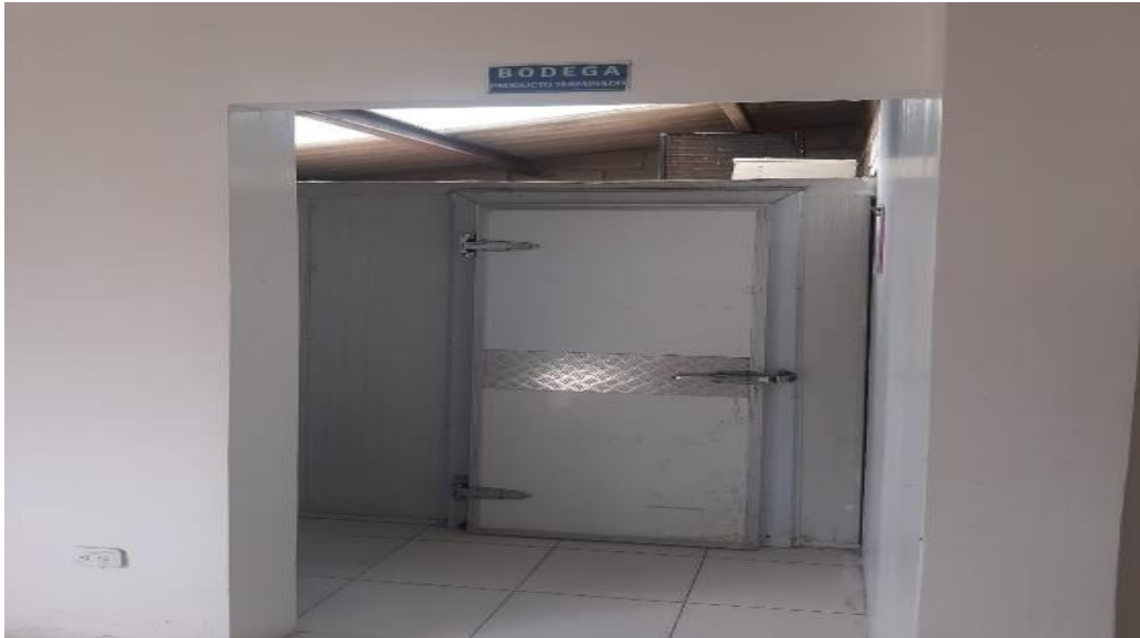
Figura 9 Área de Bodega
