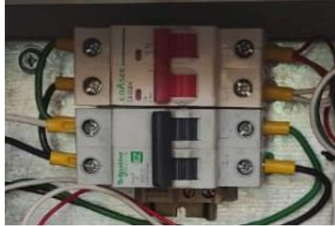
Figura 36: Posición de funcionamiento de breakers dentro del tablero eléctrico
