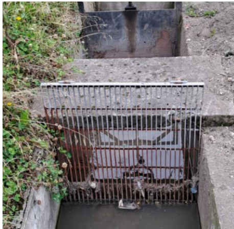
Figura 20. Rejilla de la PTAR "Andahualo"
