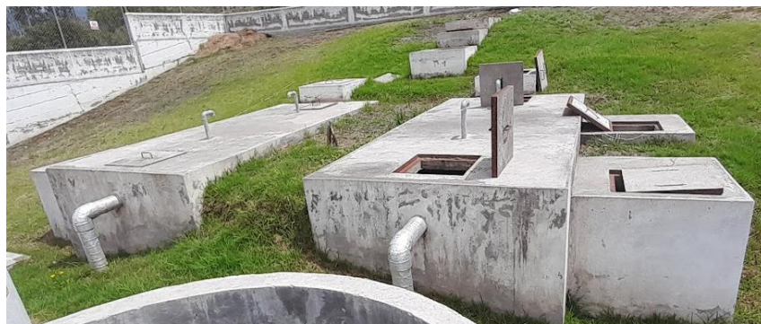
Fig. 36 Tanques Sépticos que reciben el caudal y las desfogan a los lechado de secado de lodos.
