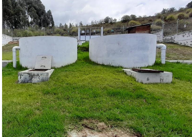
Fig. 39 Vista de las Tubería de Salida de los FAFAs.
