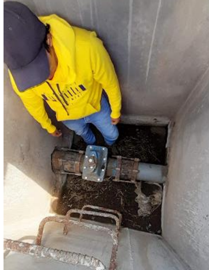
Fig. 37 Válvula Tipo que conecta la Cámara del Tanque Séptico con el Lecho de Secado de Lodos.
