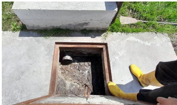
Fig. 35 Entrada del agua residual al Tanque Séptico. Se observa acumulación de lodos y natas
