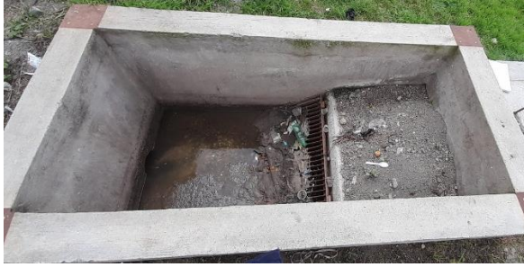
Fig. 31 Acumulación de basura y residuos sólidos, por falta de limpieza y mantenimiento.
