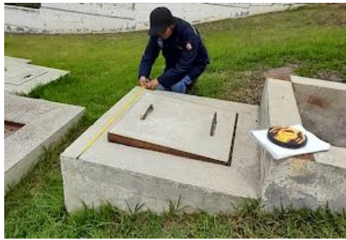
Fig. 32 Caja que en su interior contiene una válvula que regula el paso del agua residual del tanque repartidor hacia la caja repartidor de caudales.
