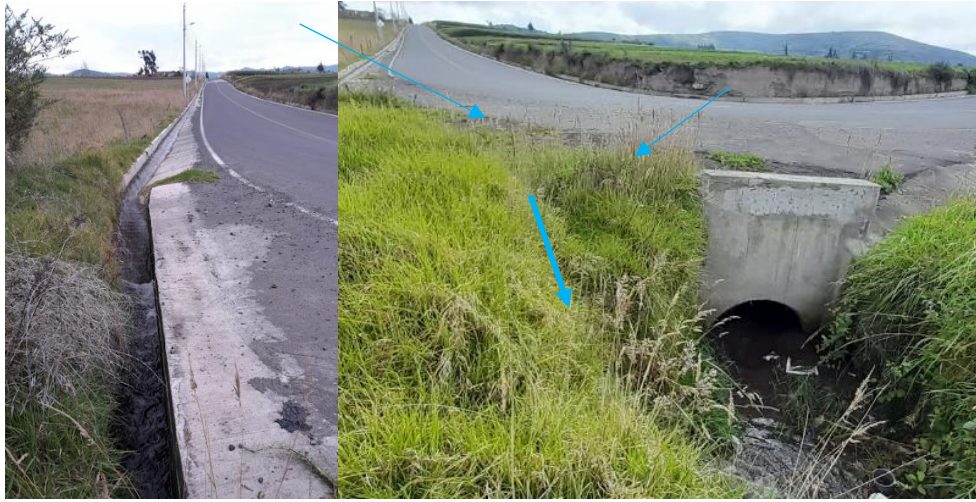
Fig. 18 Desfogue del agua lluvia y regadío en dirección a la Quebrada Seca.
