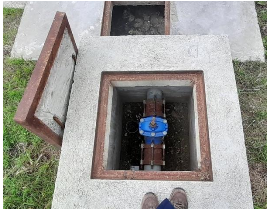
Fig. 34 Válvula que regula el paso del agua residual de la caja repartidora de caudal hacia el Tanque Séptico.
