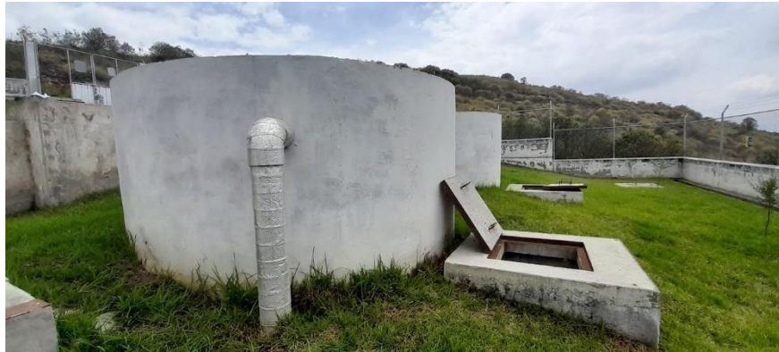
Fig. 59 Vista de las válvulas conectadas a los FAFA que desfogan los lodos sedimentados en la zona baja de la misma. Fuente: Vinicio Ortega
