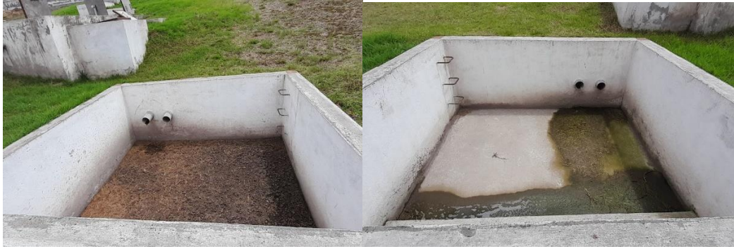
Fig. 41 Lechos de Secado de Lodos que reciben los lodos sedimentados en los Tanques Sépticos.
