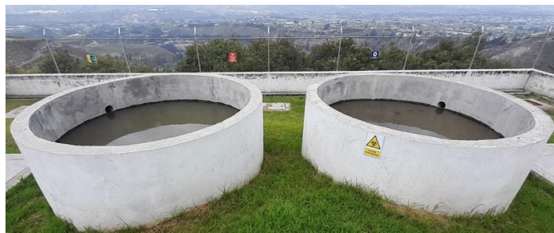
Fig. 38 FAFA 1 Y FAFA 2 de la PTAR.
