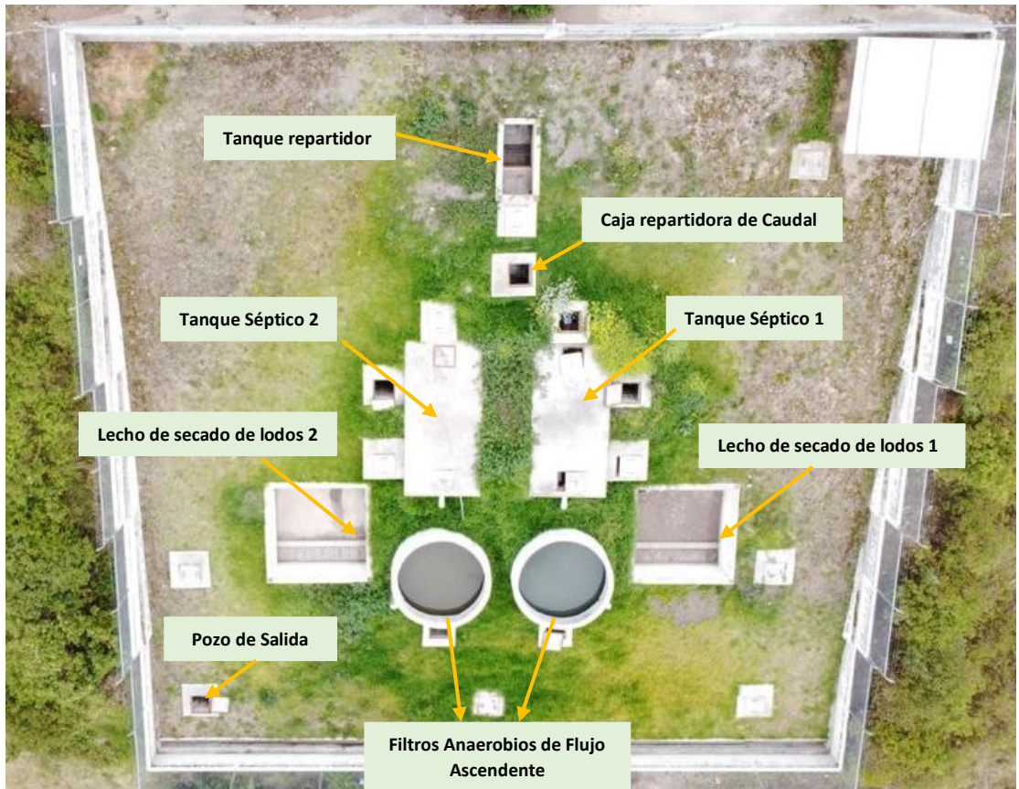
Fig. 19 PTAR de Cardo Santo – parroquia San Andrés-cantón Santiago de Píllaro Fuente: Vinicio Ortega
