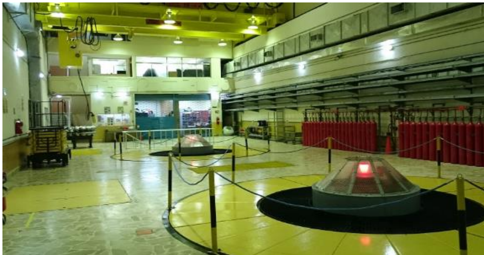
Ilustración 8 Casa de máquinas de la Central Hidroeléctrica Pucará [35]
