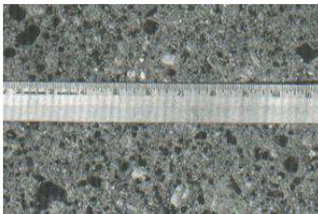
Gráfica 25: Falla del Pavimento Rígido – Desgaste superficial
