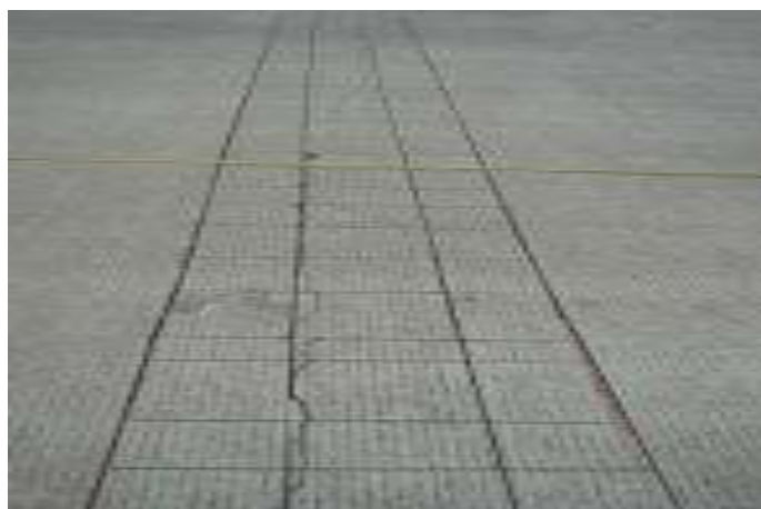
Gráfica 28: Falla del Pavimento Rígido – Excesiva Rugosidad
