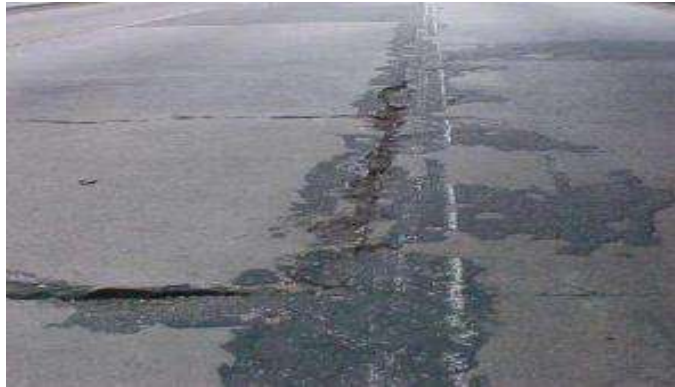
Gráfica 24: Falla del Pavimento Rígido – Descascaramiento
