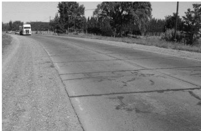
Gráfica 27: Falla del Pavimento Rígido – Excesiva Rugosidad
