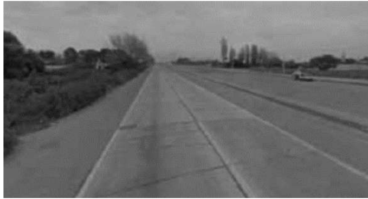
Gráfica 31: Falla del Pavimento Rígido – Desintegración
