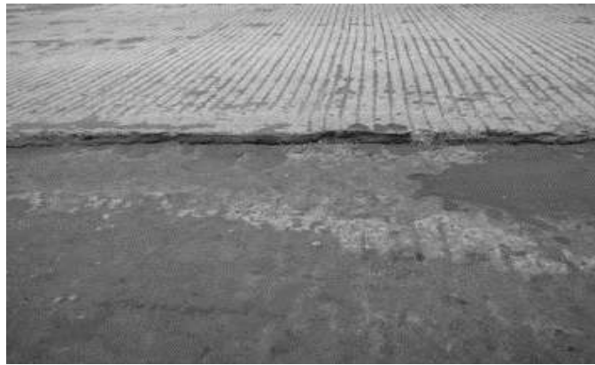
Gráfica 35: Falla del Pavimento Rígido – Levantamiento de juntas
