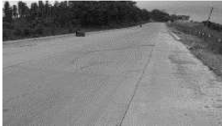
Gráfica 30: Falla del Pavimento Rígido – Agrietamiento de Esquina
