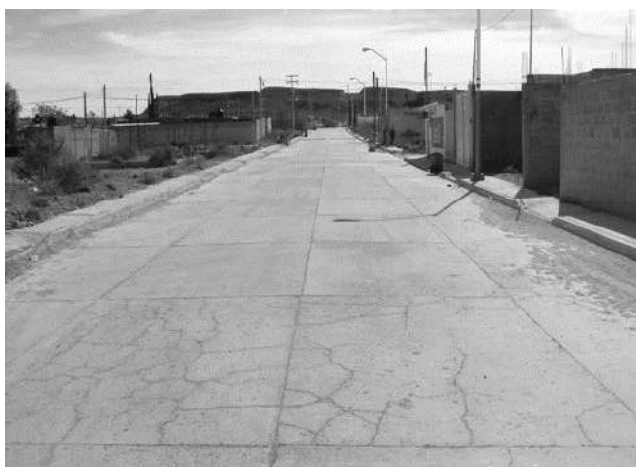
Gráfica 26: Falla del Pavimento Rígido – Fisuramiento
