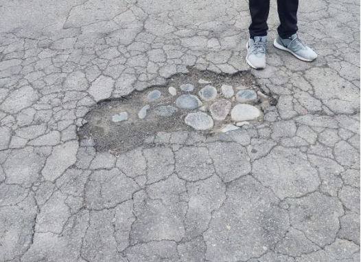
Fotografía 9.- Evaluación visual de la cantidad de baches existentes
