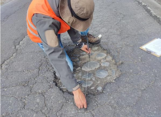
Fotografía 10.- Medición de la profundidad de los baches para su clasificación
