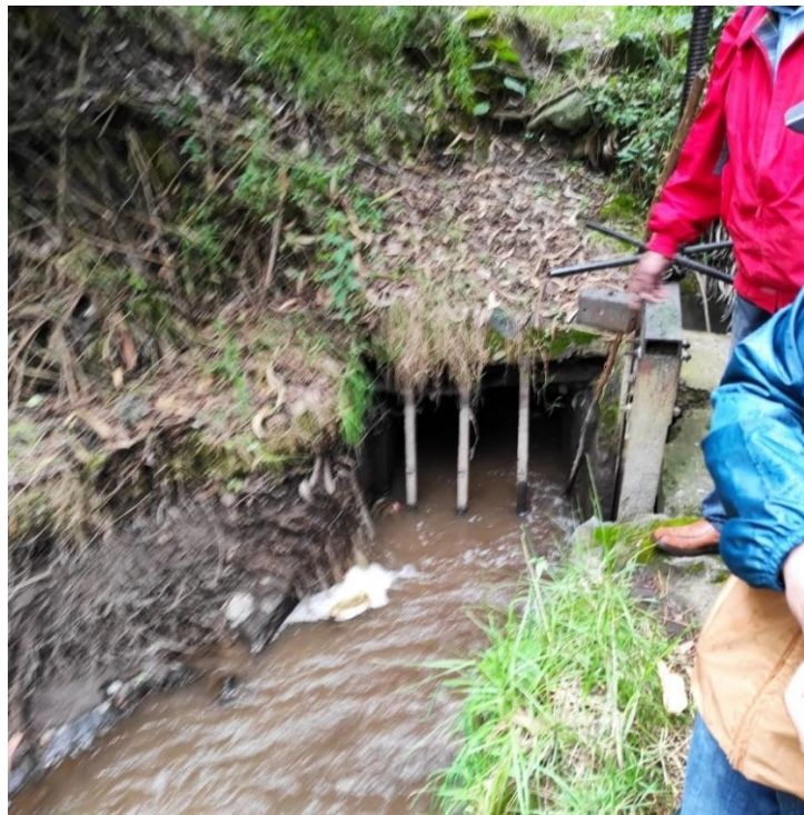
Figura 29. Estado de rejilla y canal de excedente
