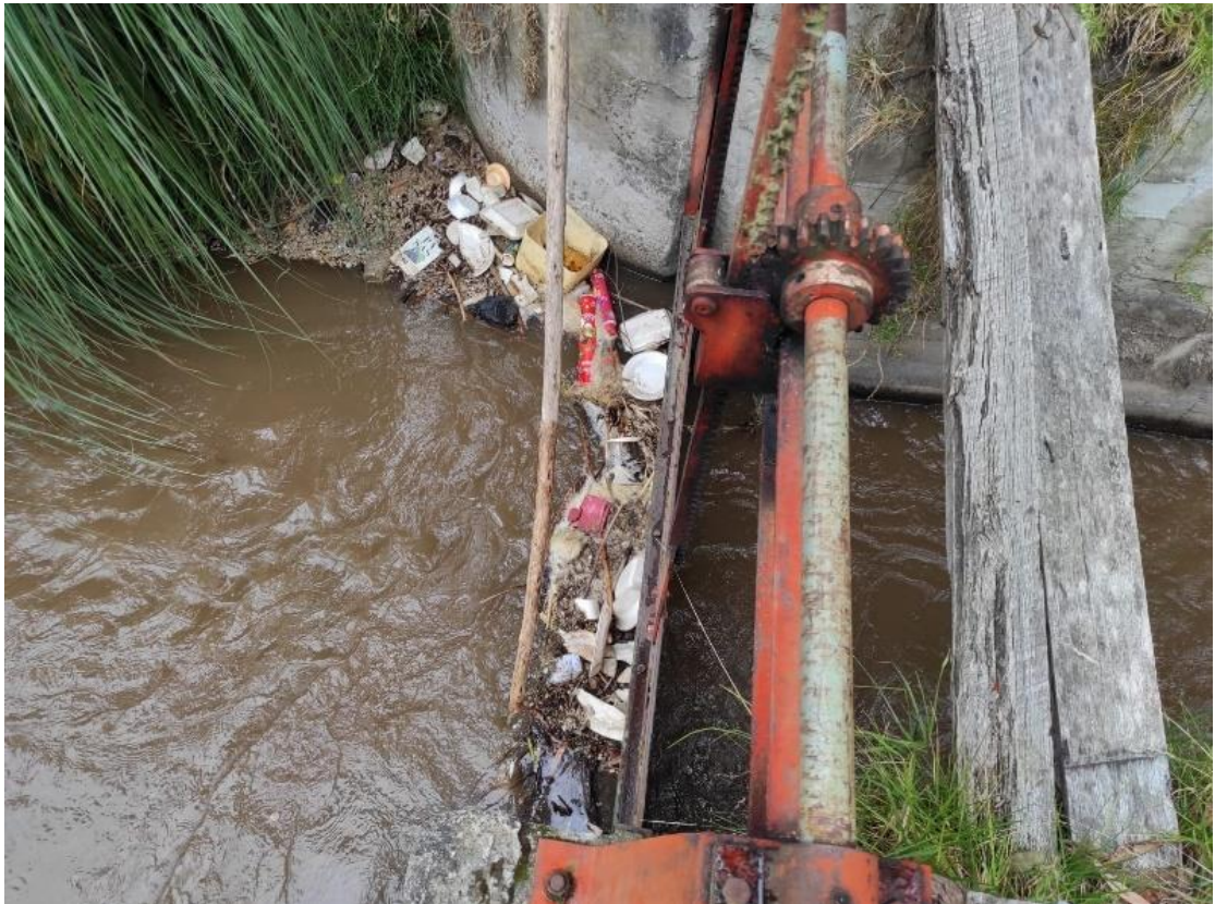
Fotografía N°1. Acumulación de sólidos en la entrada de la bocatoma
