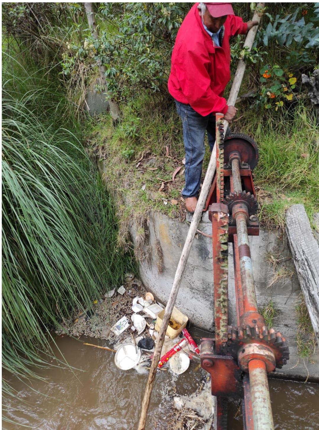
Fotografía N°2. Remoción de sólidos por parte del aguatero de la acequia.
