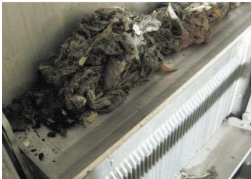
Figura 43. Recolección de sólidos en la rejilla autolimpiante.
