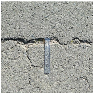
FOTOGRAFÍA 3: Grieta longitudinal – Abscisa 8+020
