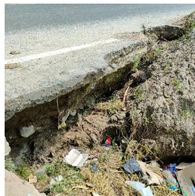
FOTOGRAFÍA 6: Agrietamiento de borde – Abscisa 8+500
